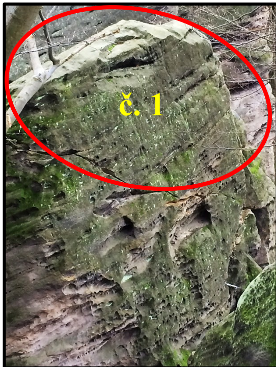
Obrázek 30. Nestabilní blok č.1 na vrcholu věže; pohled ze severovýchodní strany
