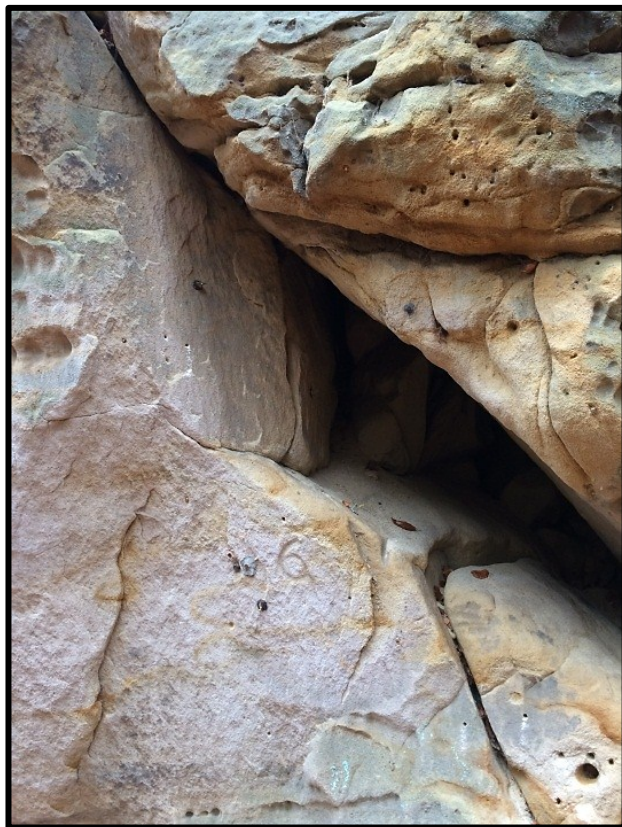
Obrázek 74. Hlavní puklina na věži
