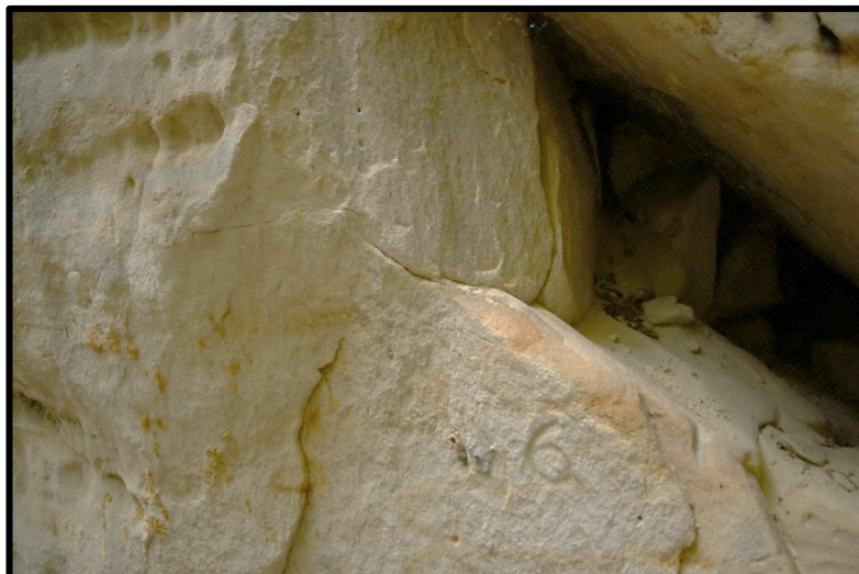
Obrázek 50. Puklina před vyčištěním
