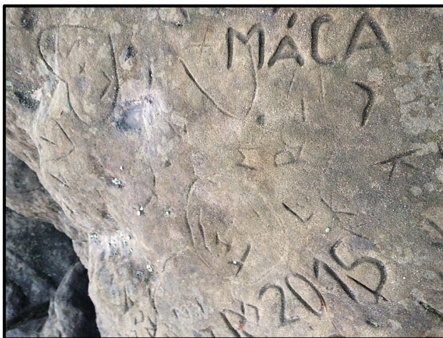
Obrázek 48. Povrch pískovce poškozený turisty
