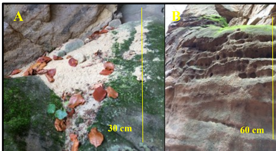
Obrázek 67. A - písek ve stokovém kanálu; B – viditelné stopy po stékajícím písku
