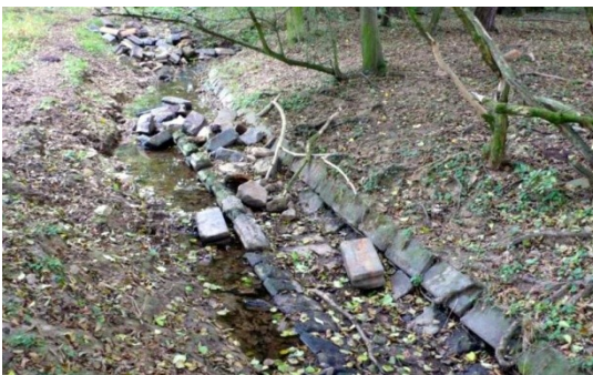
Obr. 1: Rozpad opevnění (zdroj: Just, 2011)
