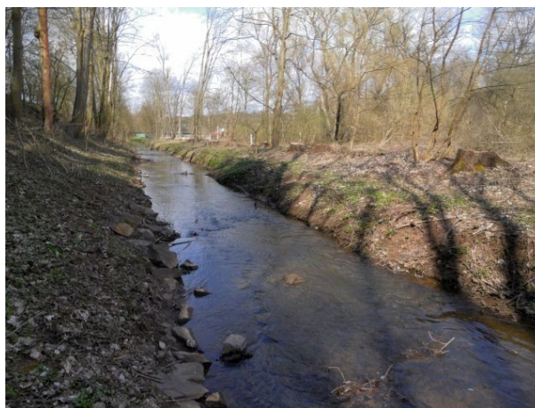
Obr. 58: Lišanský potok v úseku LIS003- dobře patrný je rozpad opevnění na levém břehu
