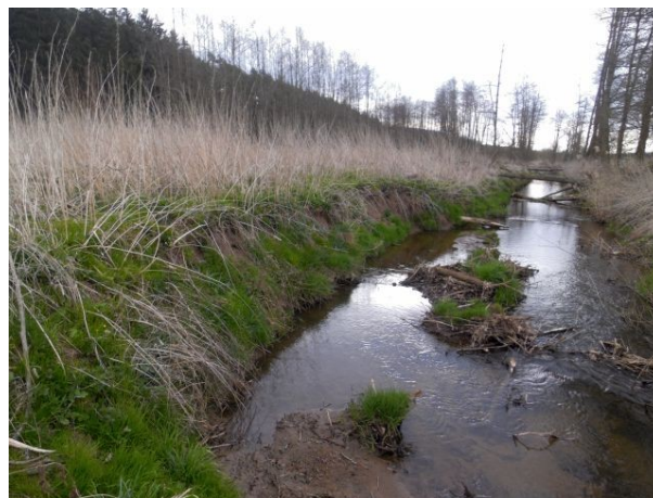
Obr. 54: Rozsáhlá břehová nátrž v úseku LIS014
