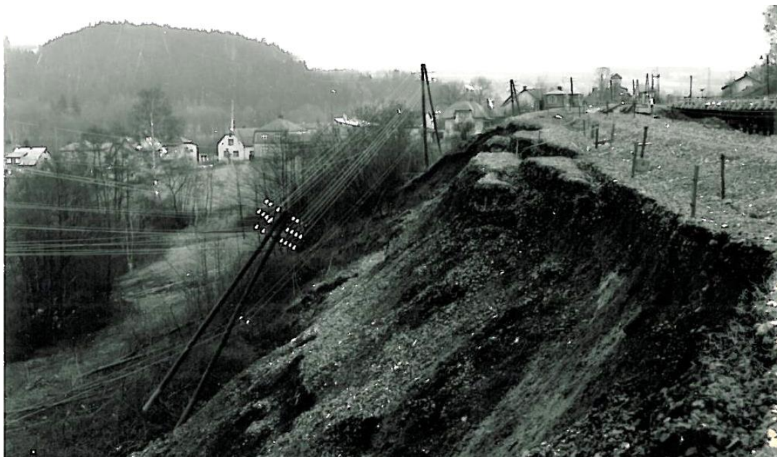
Obrázek 6 Východní část strmé odlučné stěny v tělese násypu. Zdroj: Rybář, Pašek 1975.
