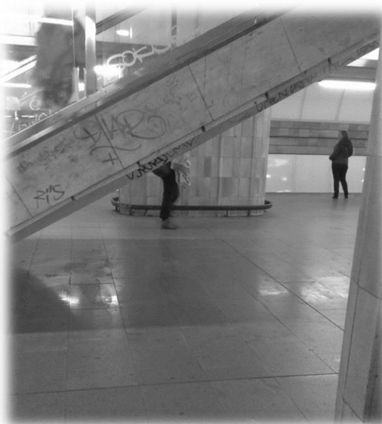
Obr. 10 Schodiště bez spodní zarážky, zdroj: autorka
