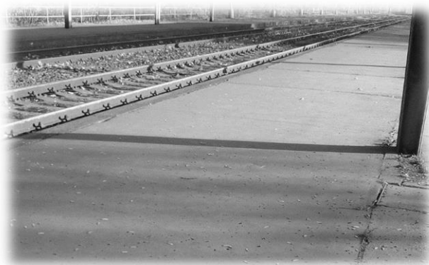
Obr. 12 Nástupiště bez varovného pásu, zdroj: autorka
