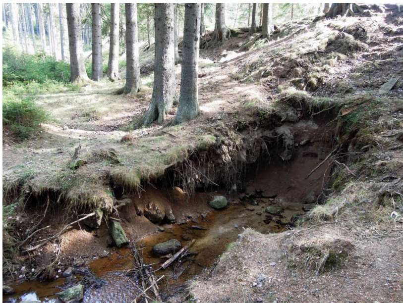
Obrázek č. 15: Poškozená hráz Kapelníkovy rybníka s vývěrem prosakující vody
