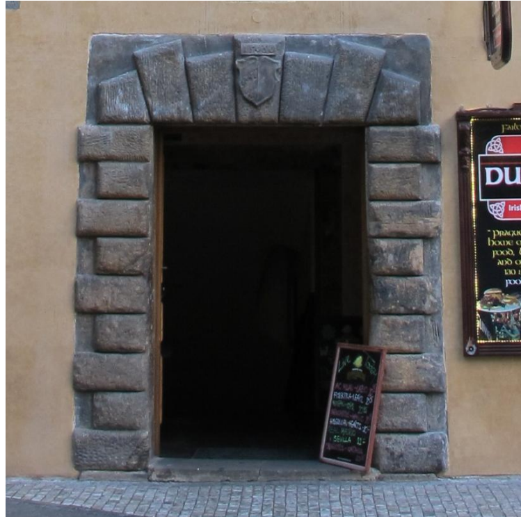
22. Praha , Staré Město, palác Granovských v Ungeltu, po 1558, dnešní dům čp. 639, portál s letopočtem 1560
