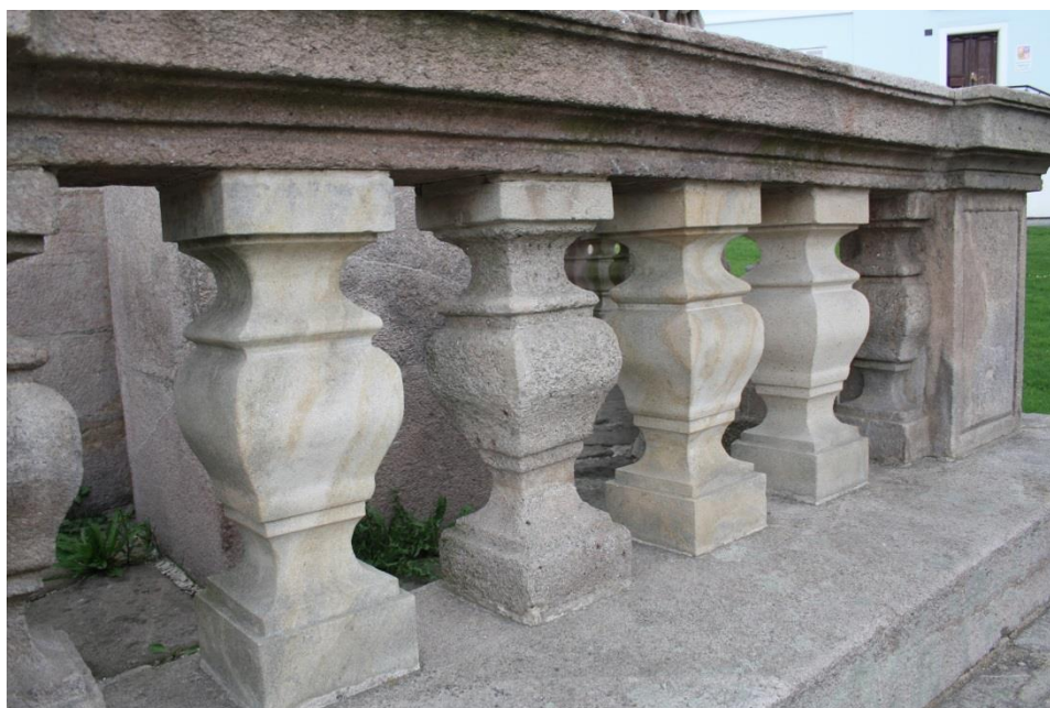
Obr. 29. Balustráda sloupu Nejsv. Trojice v Teplé na Masarykově náměstí. Nově osazené kuželky balustrády z pískovce v kontrastu s dříve použitým kamenným materiálem.
