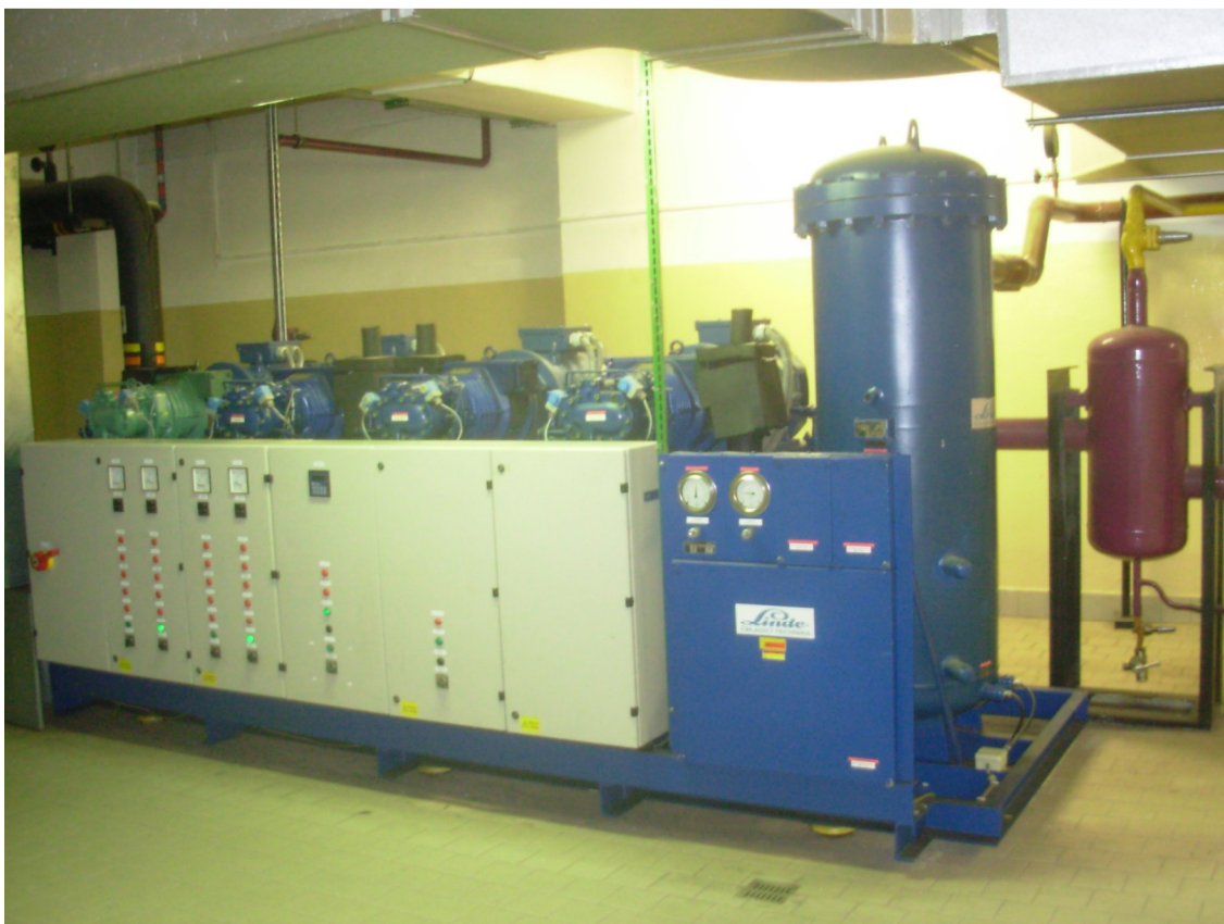
Obr. 7 - Sdružená kompresorová jednotka umístěná ve strojovně Tipsport arény firmy Linde
