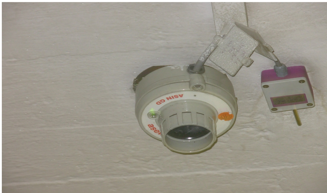
Obr. 11 - Čpavkové čidlo u stropu v místnosti s expanzní nádobou
