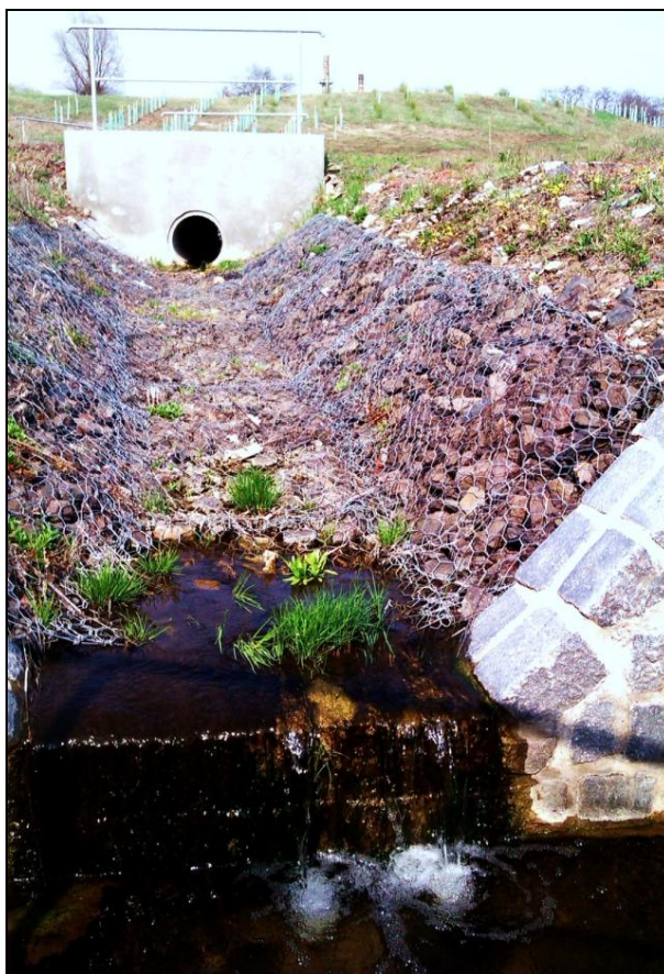
Obr. 8: Odběrové místo přítoku „Pod ocelárnou“(PO).
