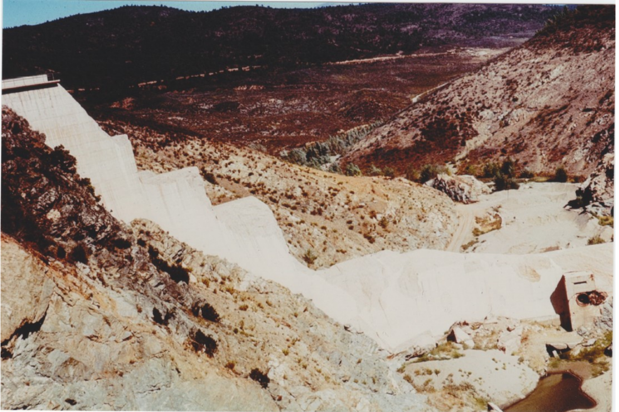
Obr. 4.6 Zřícení přehrady Malpasset - vylomení v betonu hráze na pravém břehu (archiv K. Drozd)
