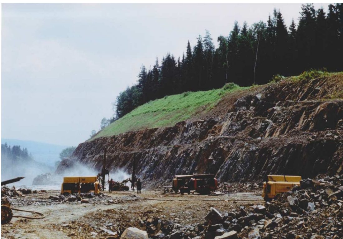
Obr. 9.7 Hloubení třetího a posledního hloubkového pásma zářezu nad niveletou dálnice pomocí clonových odstřelů (foto a text K. Drozd, 1974).
