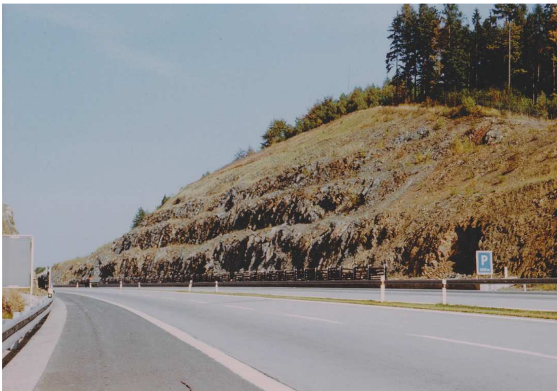
Obr. 9.4 Celkový pohled na pravý svah zářezu dálnice jen s náznaky nedokonalých laviček a s úpravou patní zídky se zábranami proti pádu kamenů na vozovku (foto a text K. Drozd, 1974).
