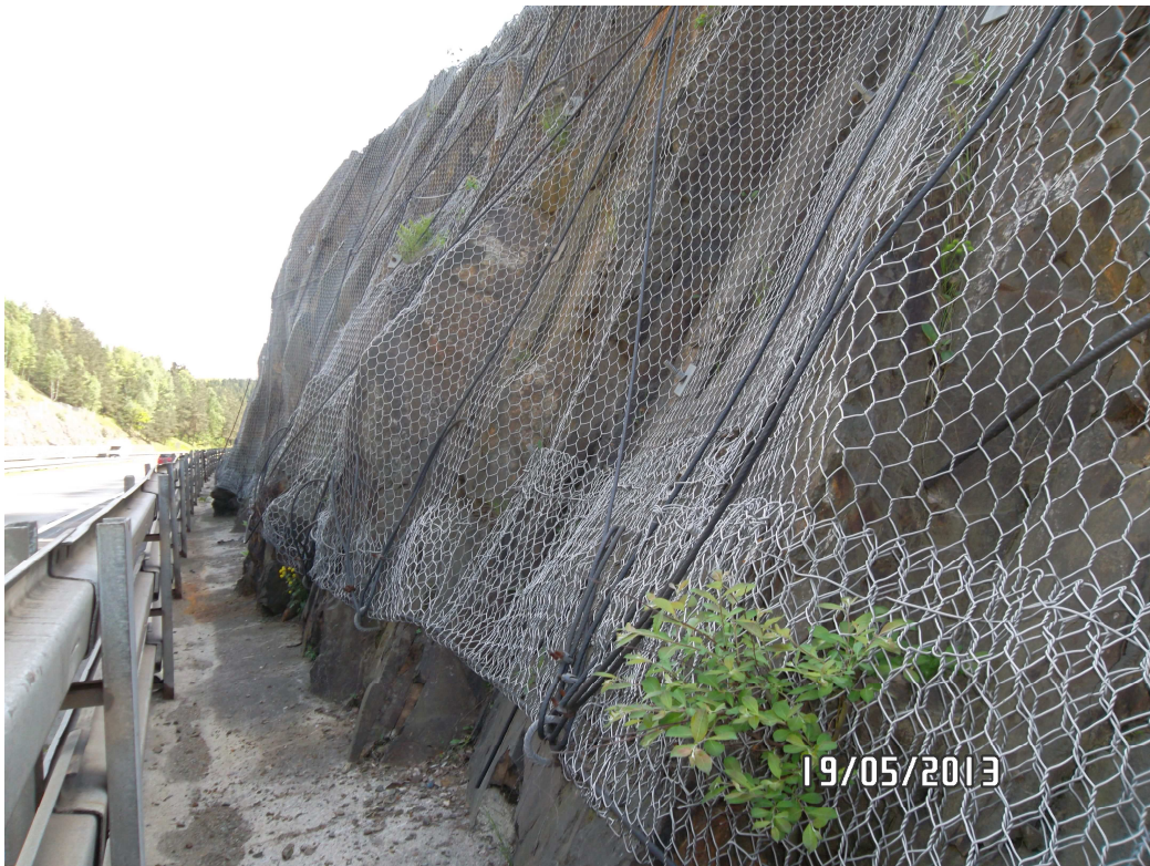
Obr. 9.29 Lensedelský zářez – detail ochranných ocelových sítí (pravý svah, 05/2013).
