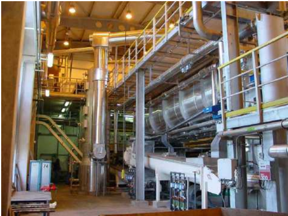
Sušárna na kaly z ČOV Modřice
