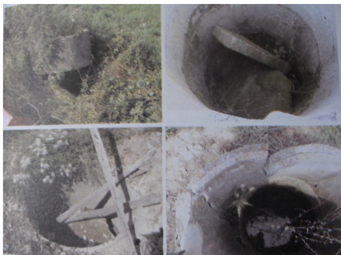
Obr. 19: Ukázka kritického stavu některých objektů zemědělského odvodnění [40]
