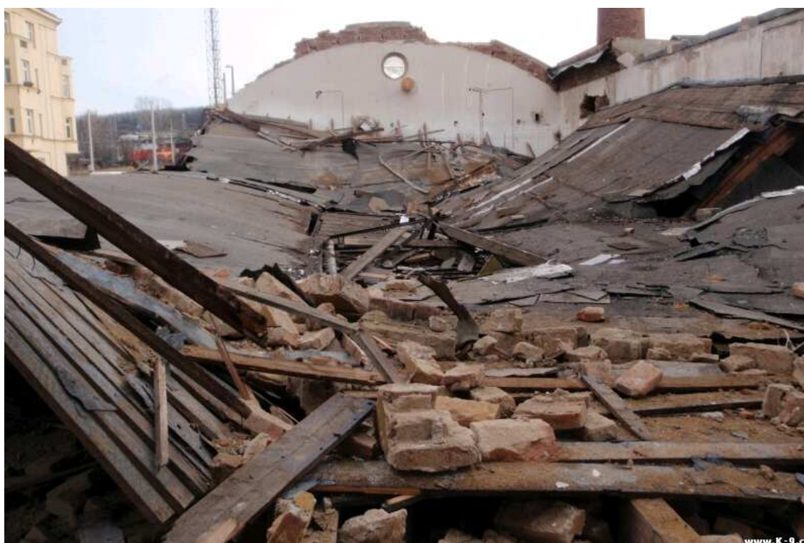
Obrázek č.5 Zřícení střechy v Praze 9 (URL16)
