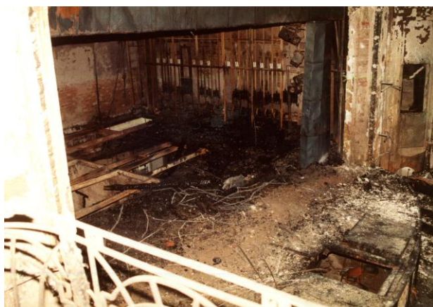
Obrázek č. 20 jeviště po požáru v roce 1994 22
