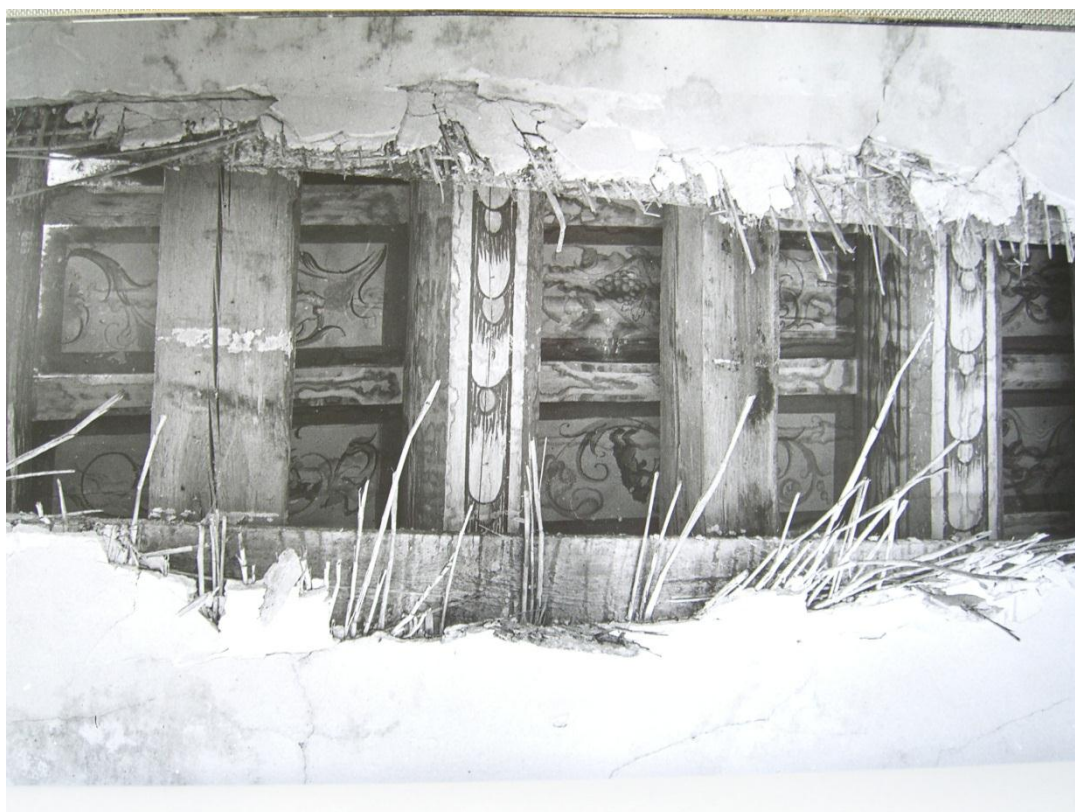
43. Stropy, stav 1976, některá podlaží jsou již zcela propadlá
