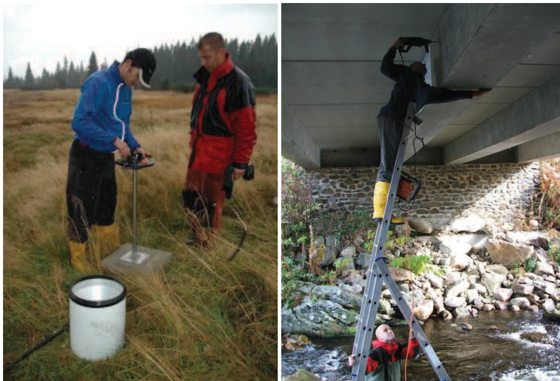
Obr. 23 Instalace člunkového srážkoměru v profilu Rokytka (vlevo) a ultrazvukového hladinoměrného čidla na mostní konstrukci v závěrovém profilu Modravského potoka (vpravo; foto: autor)
