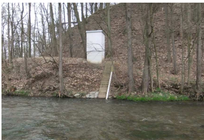
Obrázek č. 19: Vodoměrná stanice Zlích
