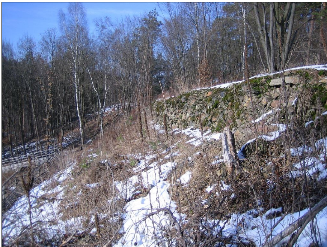
Obrázek 33: Odkrytá zeď z lomového kamene v náspu, na mapě značeno číslem 2 (foto březen 2010)
