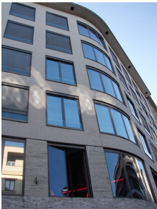
[41] Antonín Novák/ Tomáš Rusín/ Petr Valenta/ Ivan Wahla: Budova Dopravní podniku města Brna, Novobranská ulice, 2000-2001, (současný stav- detail fasády nad vstupní osou)
