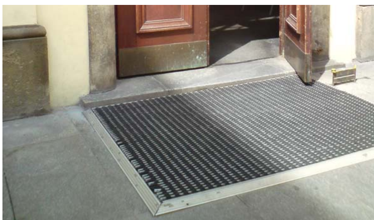
Obrázek 4 Nesprávně vyřešený vstup, NK ČR
