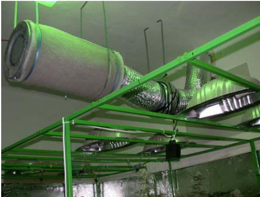
Obrázek č. 18 – vzduchotechnika v pěstírně konopí
