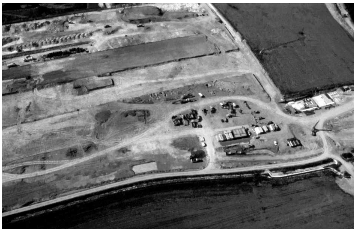
Obr. 2. Kněževs, okr. Praha-západ. Východní část zkoumané plochy se zařízením staveniště po ukončení výzkumu, kdy již byl terén planýrován a bagrován před výstavbou skladových hal. Foto M. Gojda
