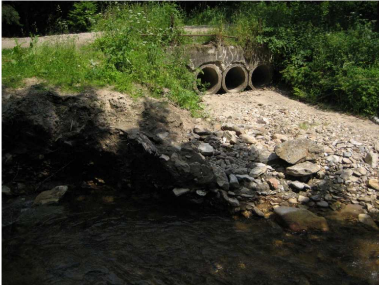
Obr. 71 Nevhodně dimenzovaný most na Pravětínském potoce vytvořený propustky, voda si vytvořila nové koryto. Foto: Z. Rettichová
