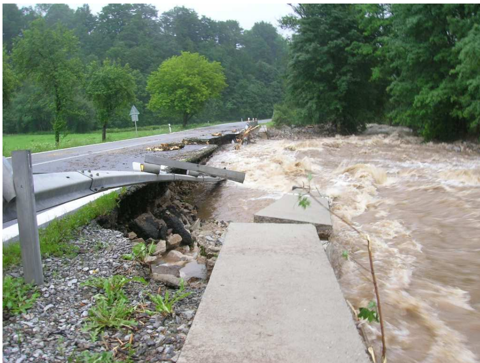
Obr. 78 Průběh povodně 2009, poničená komunikace. Foto: Kotál 2009
