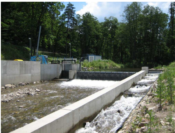
Obr. 28 Jez v Bohumilicích, na levé straně je protipovodňová stěna, chránící průmyslovou oblast, během povodně následkem akcelerace proudění došlo k destrukci stěny a zaplavení průmyslové oblasti. Foto: Z. Rettichová
