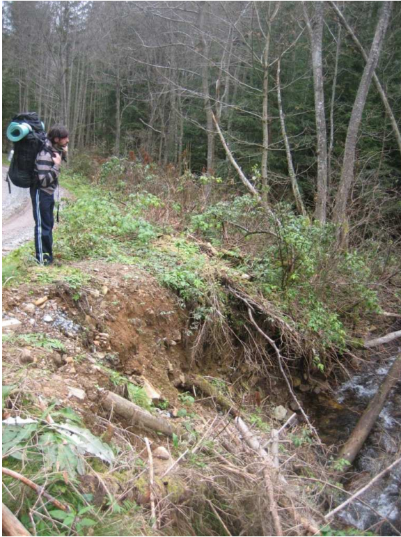
Obr. 82 Následky po povodni 2009, příklad rozsáhlé nátrže. Foto: Z. Rettichová, 2009
