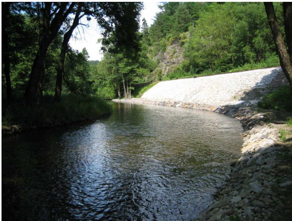
Obr. 86 Příklad úseku opraveného po povodni 2002, násep železnice se nachází v zákrutu Volyňky. Foto: Z. Rettichová, 2010
