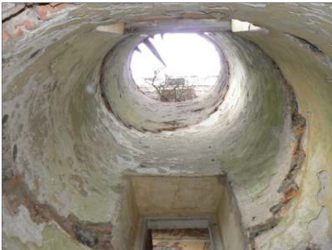
25. Pohled na zřícené schodiště vedoucí na věž, foto 2009
