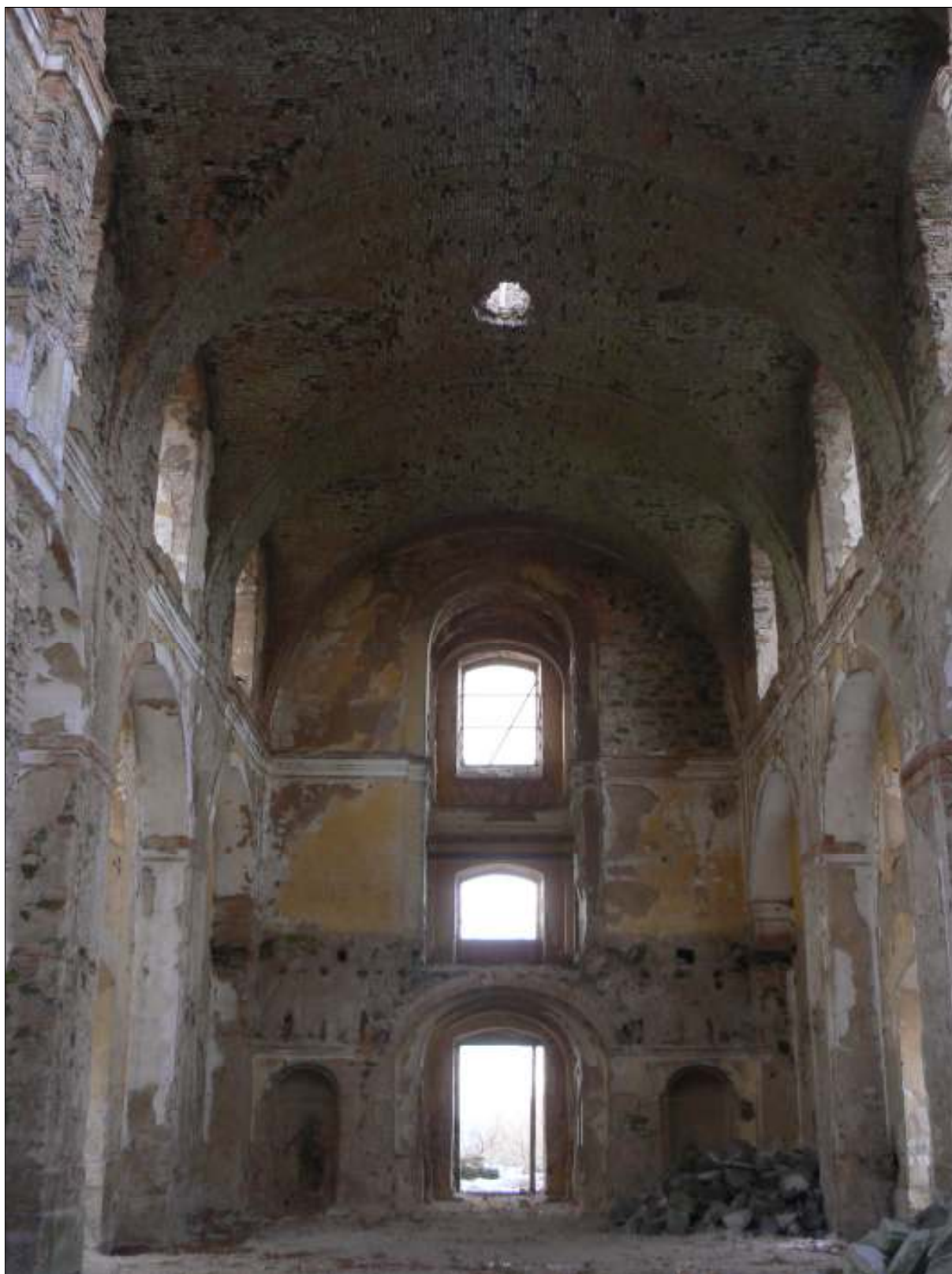
22. Pohled do lodi směrem k někdejší kruchtě, po stranách vedle vstupu patrné niky, před nimiž stávaly zpovědnice, foto 2009
