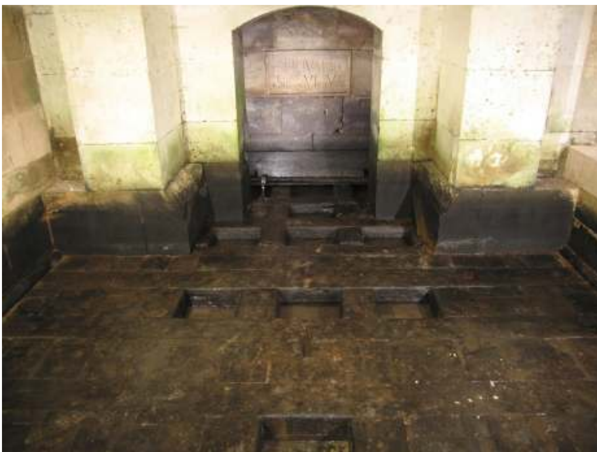
Obrázek 57: Dubový rošt jižního zrcadla ve stavu bez vody. Na stěně portálu je nápis připomínající význam vody pro tuto stavbu. Foto: JŘ
