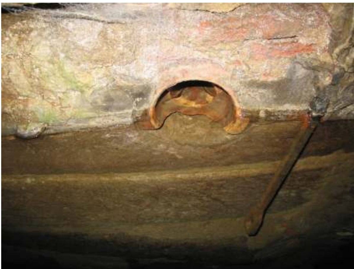
Obrázek 35: Přepad do keramického potrubí v pramenné jímce Vojtěšky. Foto: J. Řehák
