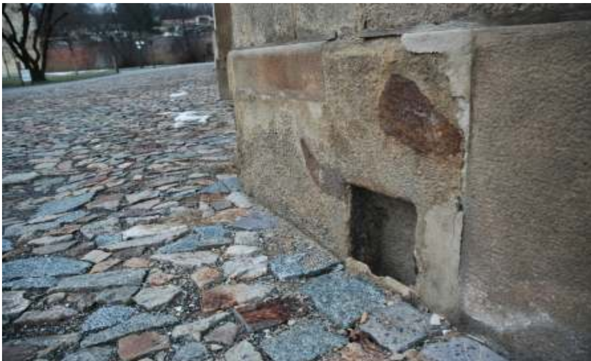
Obrázek 27: Nasávací otvor do větracího kanálu pod závěrem kostela svaté Markéty. Foto: PL
