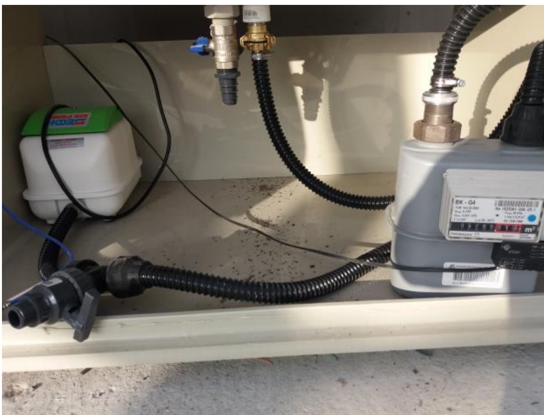
Obr. č. VII Zapojení dmyhadla a plynoměru
