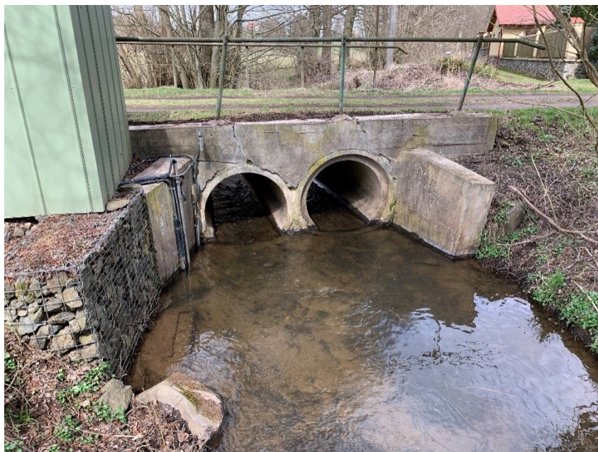
Obr. 11: Hydrologická stanice na Mladotickém potoce v obci Přehorov (foto autor)
