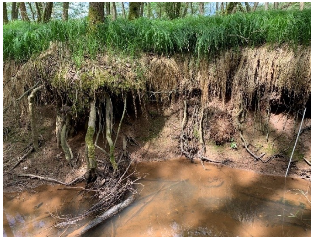
Obr. 34: Rozsáhlá břehová nátrž úseku ml-25 (foto autor)
