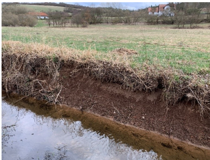
Obr. 3: Břehová nátrž na Mladotickém potoce (foto autor)
