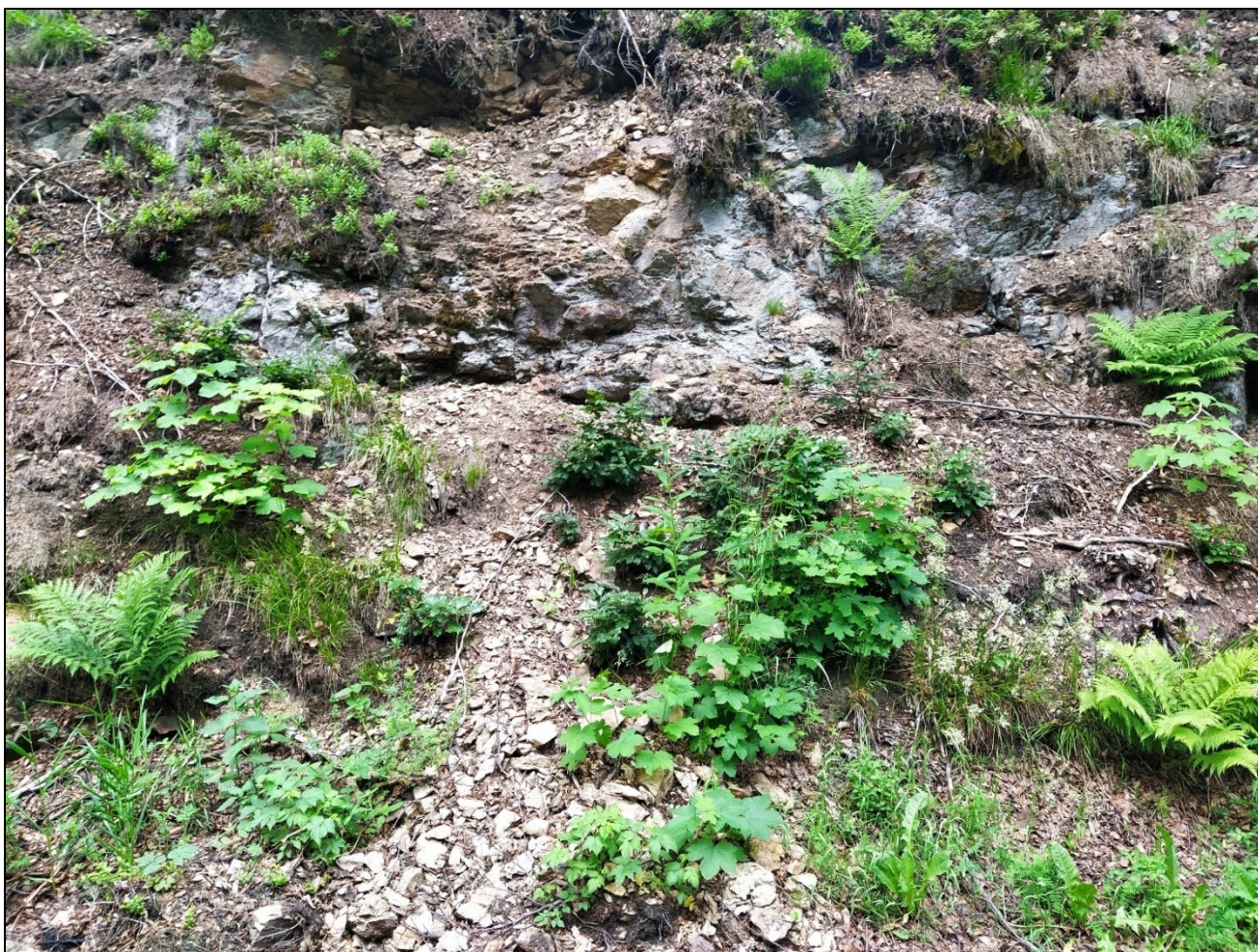
Obr. DB6: Výchoz DB6, v silničním zářezu, pohled na tektonicky porušenou polohu mírně až silně zvětralé ortoruly s vysokou až velmi vysokou hustotou diskontinuit v poloze 2–3 m.
