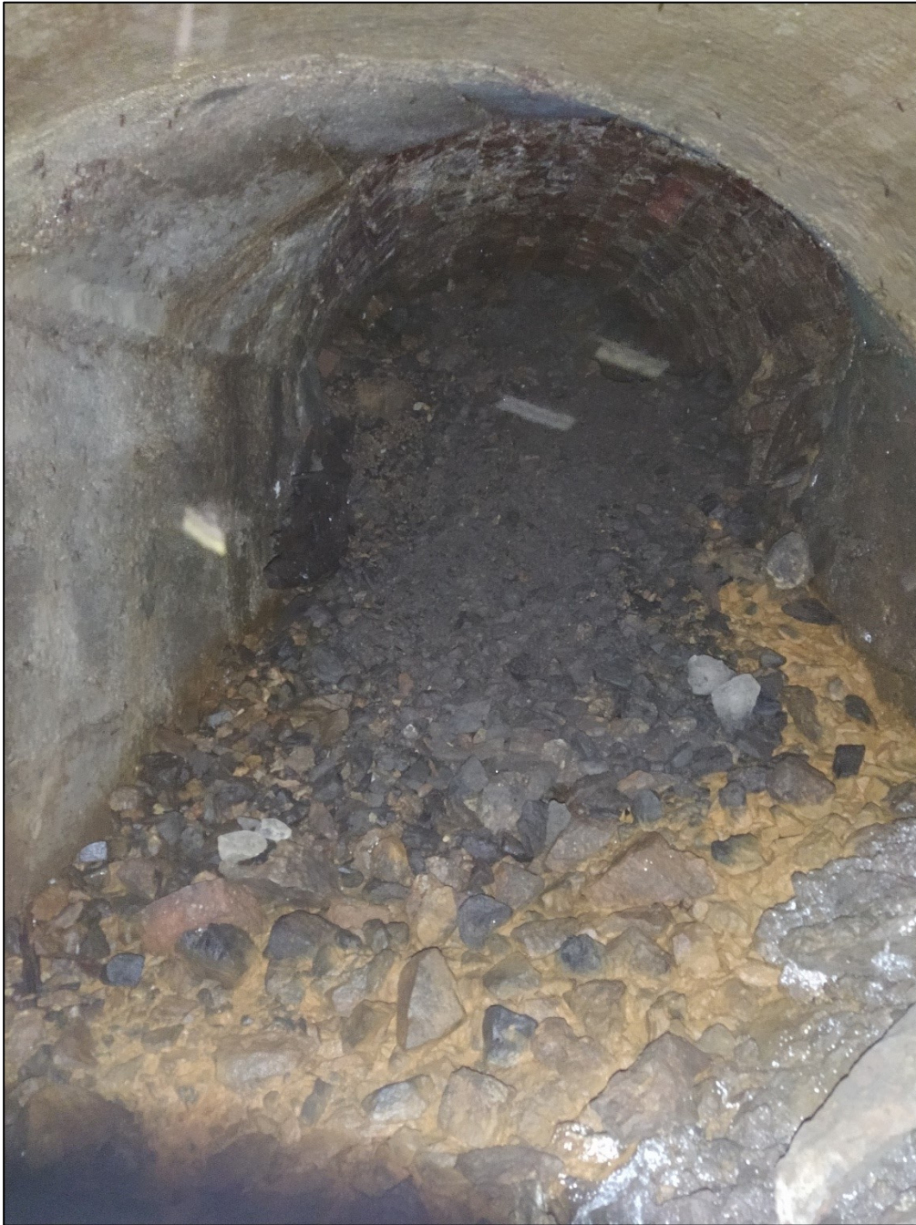
Obr. 22: Zasučení ve východní části štoly
