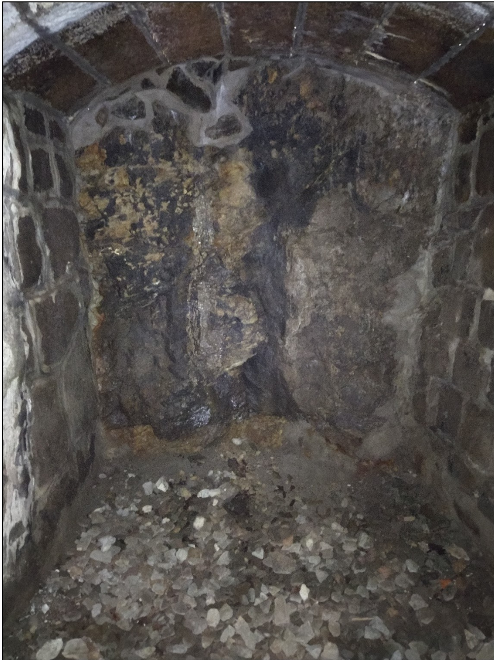
Obr. DB11a: „Okno“ v ostění uvnitř železničního tunelu se světle šedě viditelnými vyspravenými puklinami
