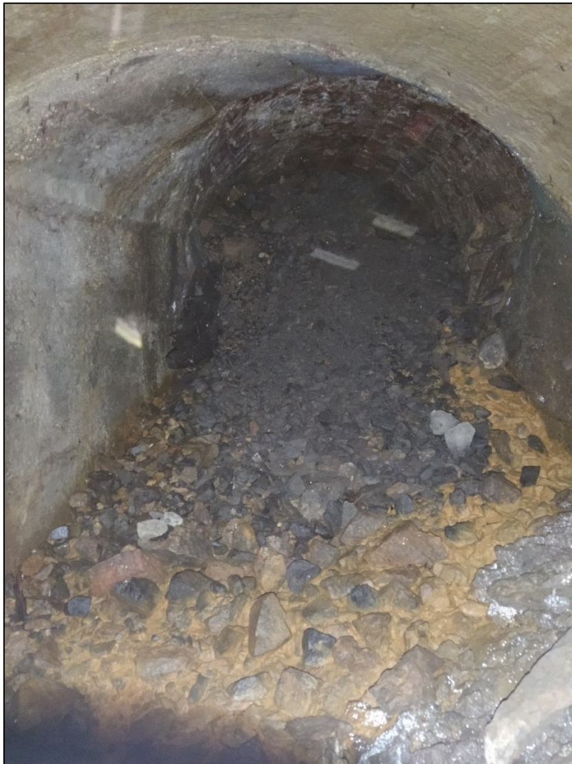
Obr. DB7: Pohled na průval na východním okraji štoly
