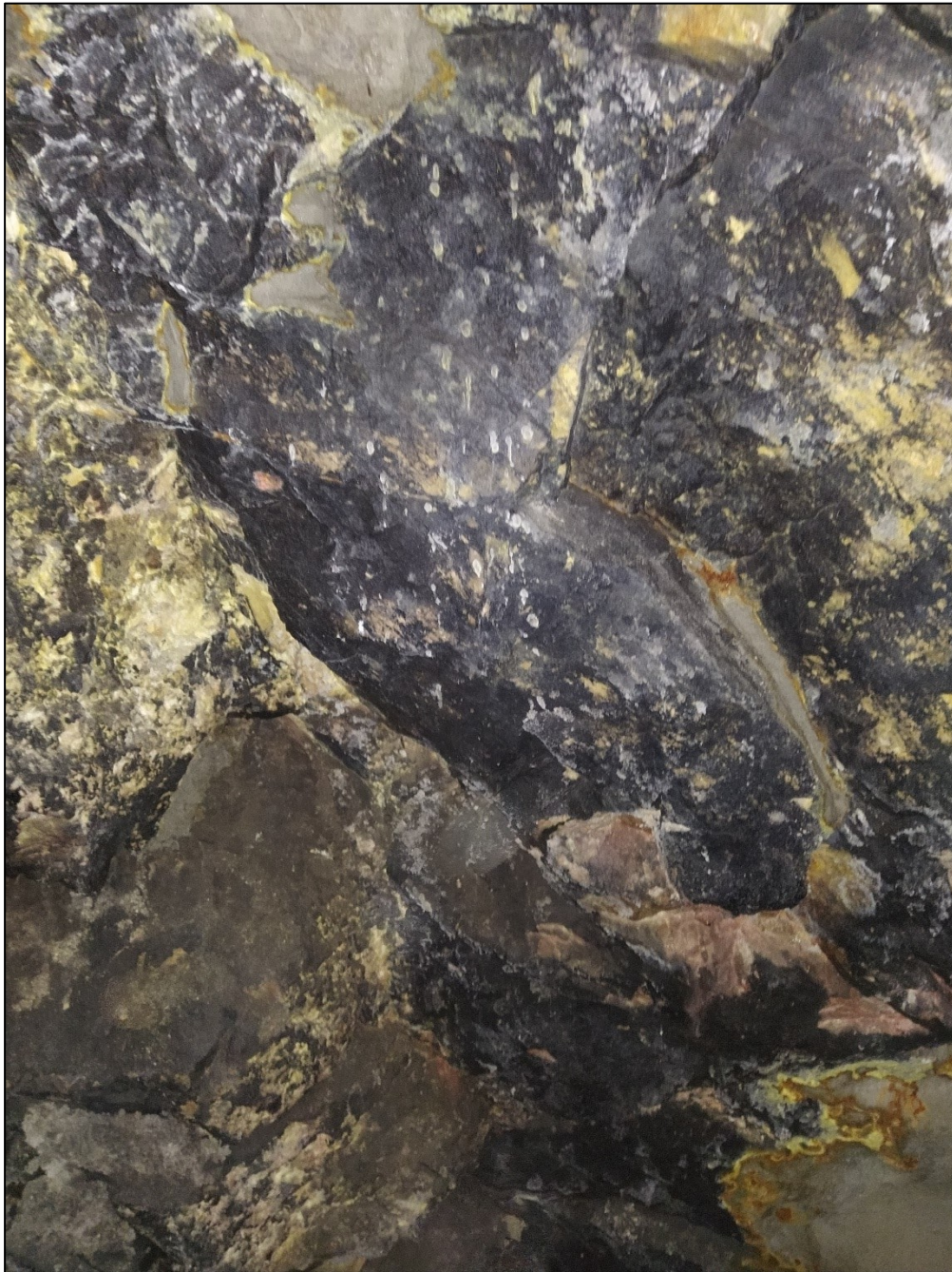
Obr. DB11b: „Okno“ v ostění uvnitř železničního tunelu se silně zvětralými nažloutlými až narezlými polohami
