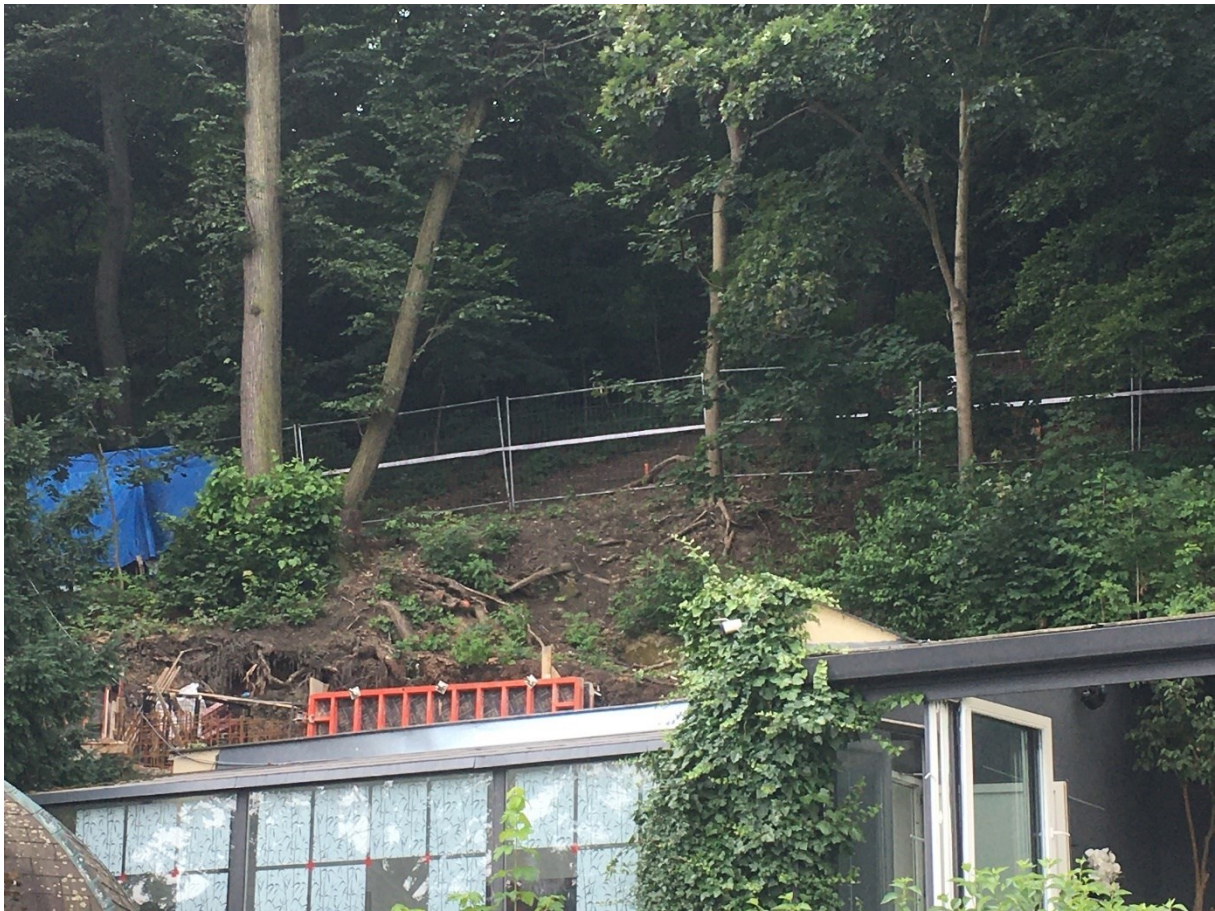
Obrázok 58: Viditeľné poškodenie svahu nad reštauráciou Nebozízek na dolnom okraji súvislého lesného porastu v svahu Petřína. Na mieste nebolo možné určiť, či sa jedná o zvýšenú eróziu pôdy alebo zrýchlenie svahového pohybu. Vzhľadom na chýbajúcu deformáciu okolitých stromov a slabý vegetačný pokryv v narušenom mieste je pravdepodobnejšia prvá možnosť. Zdroj: archív autora (júl 2021).
