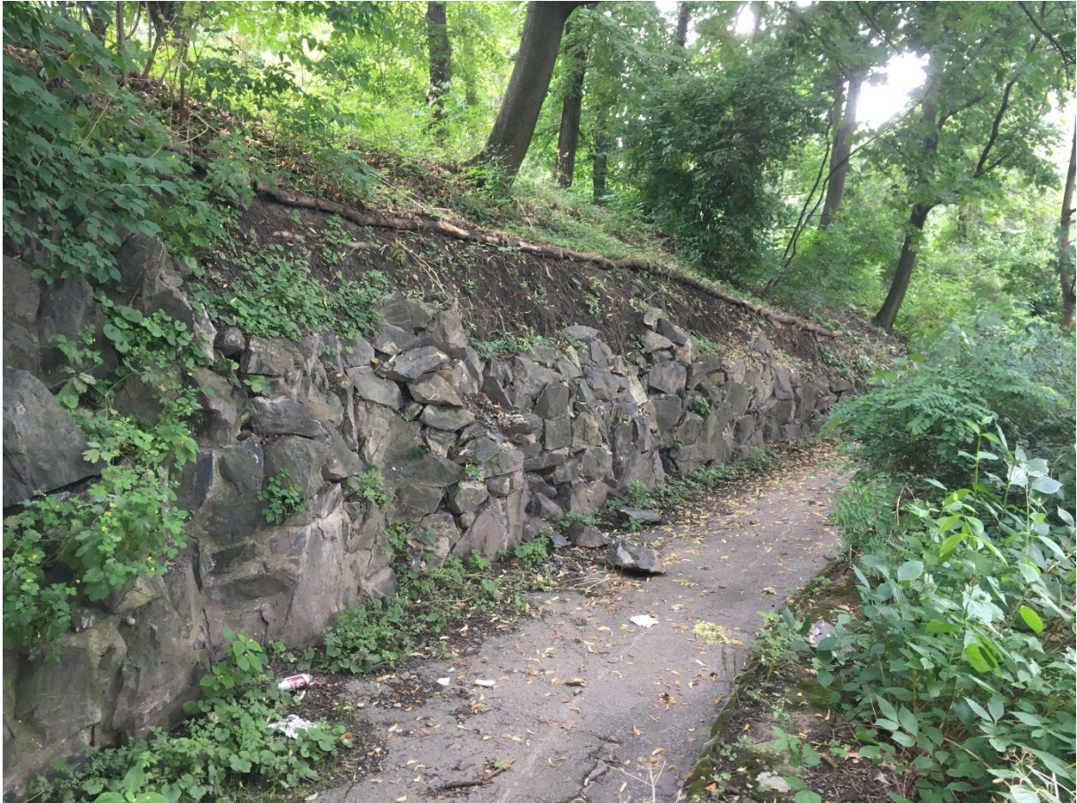
Obrázok 56: V. svah Petřína v jeho dolnej časti, približne nad zastávkou MHD Újezd, je pravdepodobne v pomalom pohybe. Svedčia o tom mierne zdeformované kmene stromov a poškodenia slabo udržiavaného oporného múru. Badateľná je tiež zvýšená erózia pôdy. Miesto na fotografii je jedným z mála v dolnej časti svahu, kde zasahuje lesný porast, a zároveň patrilo v rámci študovanej lokality Petřín medzi najmenej „zasiiahnuté“ parkovými úpravami. Zdroj: archív autora (júl 2021).
