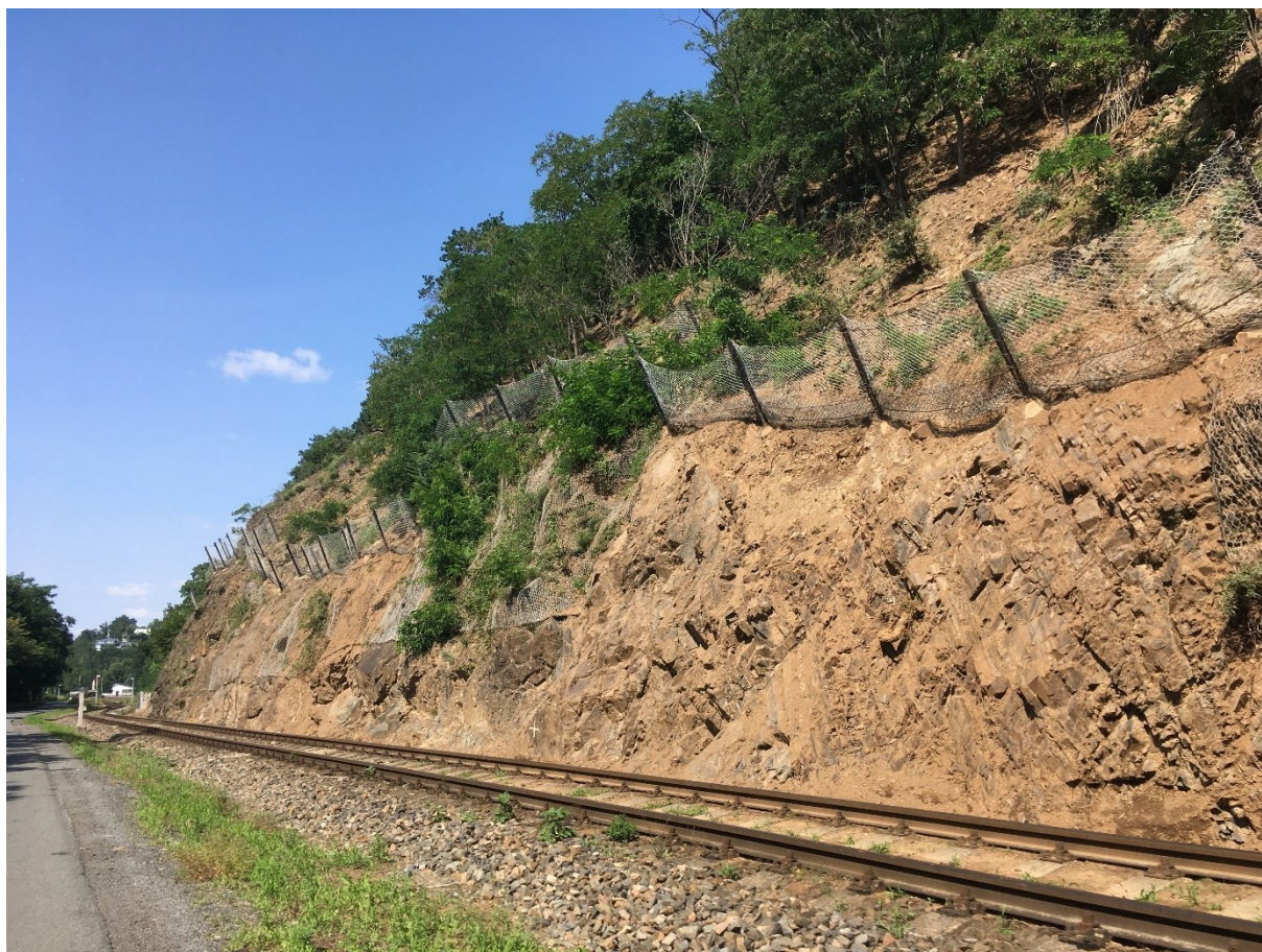
Obrázok 66: Technické opatrenia na ochranu trate pred skalným rútením proterozoických tufov a tufitov davelského súvrstvia pred južným zhlavím žst. Zbraslav. Tento úsek železničnej trate bol len necelý mesiac pred vytvorením fotografie zavalený kamenito-bahenným prúdom po privalovej zrážke, čo dokazuje prítomnosť skalných úlomkov a zvyškov bahna v kol'ajisku. Zdroj: archív autora (júl 2021).
