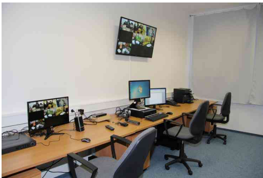
Obrázek č. 4: Technická místnost Územního odboru PČR v Písku. 148
