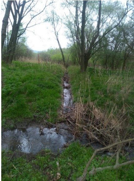
Obrázek 1: Příklad vyústění hlavního odvodňovacího zařízení do vodního toku Zdroj: Fotografie autorky (2021)
