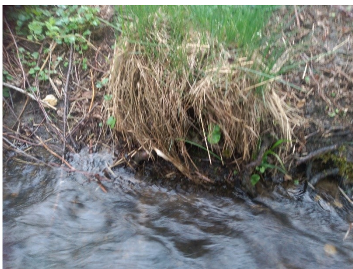
Příloha 27: Výúst odvodnění do Klíšského potoka d17tl (zatrubněná, z levé strany) Zdroj: Fotografie autorky (2021)
