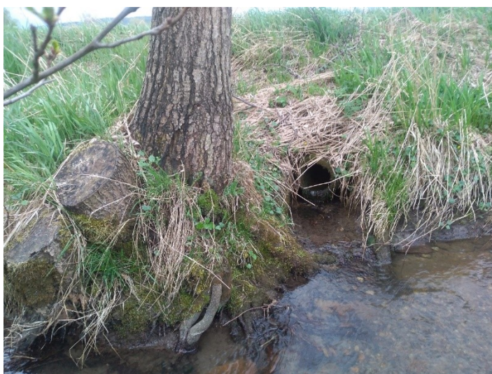
Příloha 24: Výúst odvodnění do Klíšského potoka d14tp (zatrubněná, z pravé strany) Zdroj: Fotografie autorky (2021)
