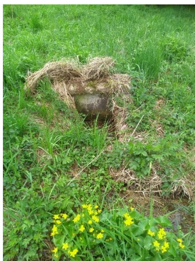
Příloha 16: Výúst odvodnění do Klíšského potoka d5tl (zatravněná, z levé strany) Zdroj: Fotografie autorky (2021)
