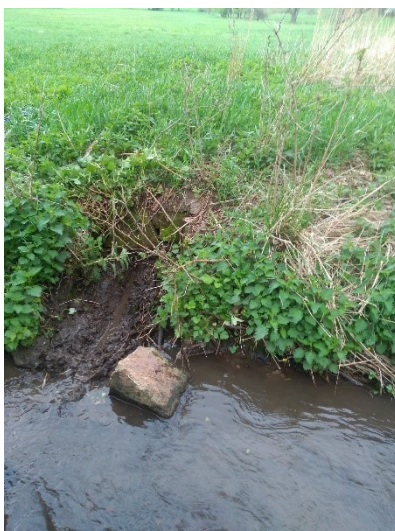
Příloha 20: Výúst odvodnění do Klíšského potoka d10tl (zatrubněná, z levé strany) Zdroj: Fotografie autorky (2021)
