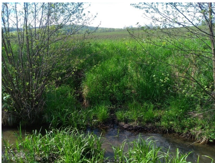
Příloha 26: Výúst odvodnění do Klíšského potoka d16pp (povrchová, z pravé strany) Zdroj: Fotografie autorky (2021)
