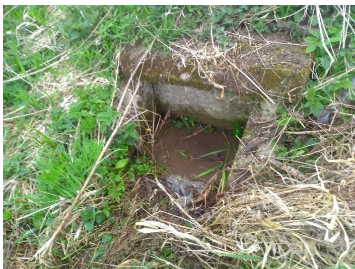
Příloha 18: Výúst odvodnění do Klíšského potoka d8tl (zatrubněná, z levé strany) Zdroj: Fotografie autorky (2021)
