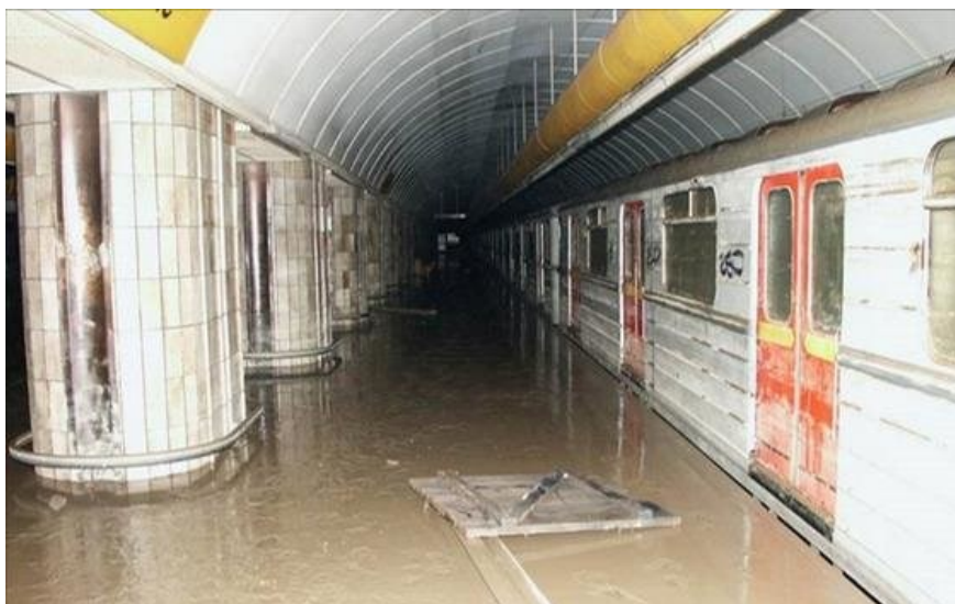
Obrázek 14 - Zaplavení stanice Florenc
