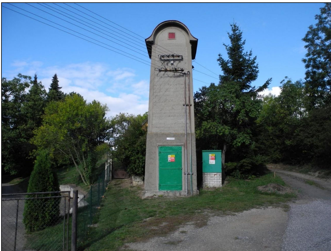
Obrázek 274. Trafostanice Obruby. Foto Jiří Chmelenský, 2015.
