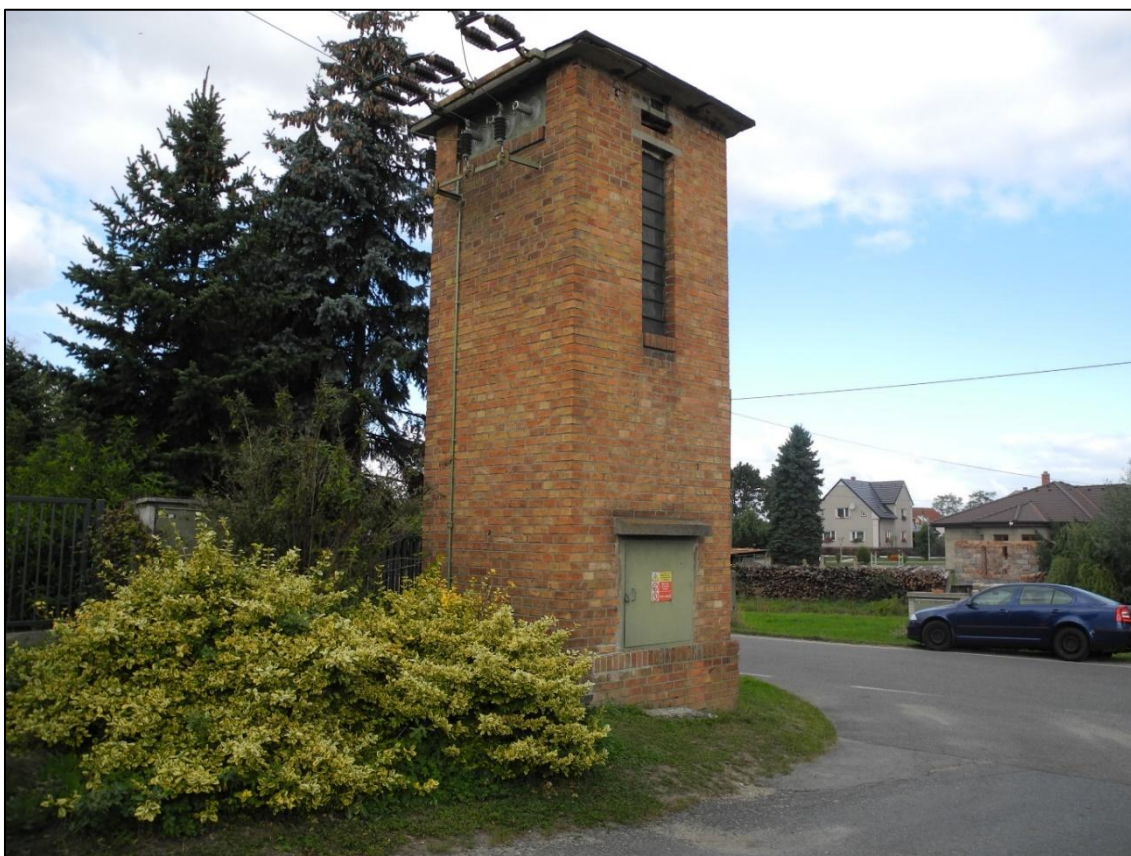
Obrázek 230. Trafostanice Dlouhá Lhota s druhotně změněným otvorem rozvaděče a vstupu vn. Foto Jiří Chmelenský, 2015.
