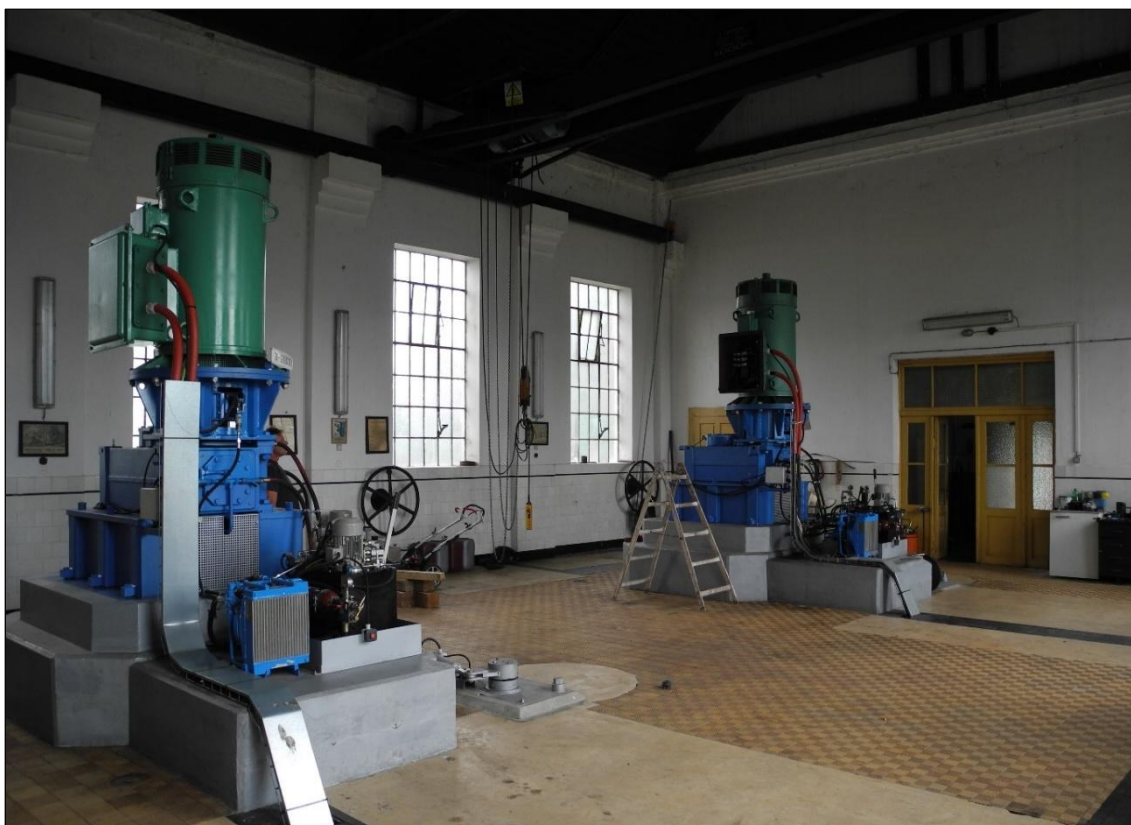
Obrázek 135. Pohled do strojovny MVE, pohled je směřován k severovýchodu. Vpravo dveře do přístavby správního objektu. Uprostřed dva nové generátory na nových podstavcích. Patrné jsou staré otisky regulace a převodů. Na severní stěně vzadu kola rychlého uzávěru turbínové kašny. Pod stropem patrný manipulační jeřáb. Foto Jiří Chmelenský, 2015.
