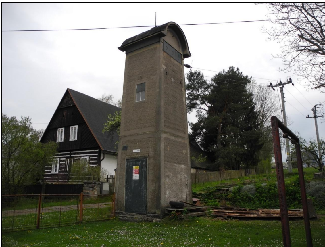
Obrázek 256. Trafostanice Loukov dochovaná pouze s modernizačními elektrotechnickými změnami navíc. Foto Jiří Chmelenský, 2015.
