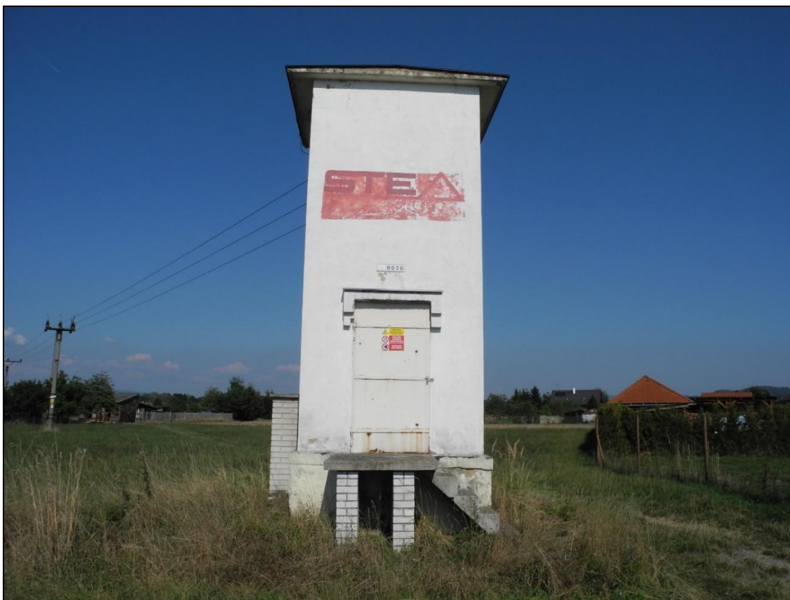
Obrázek 232. Trafostanice Doubrava, patrné jsou původní plechové dveře a překlad nade dveřmi. Foto Jiří Chmelenský, 2015.
