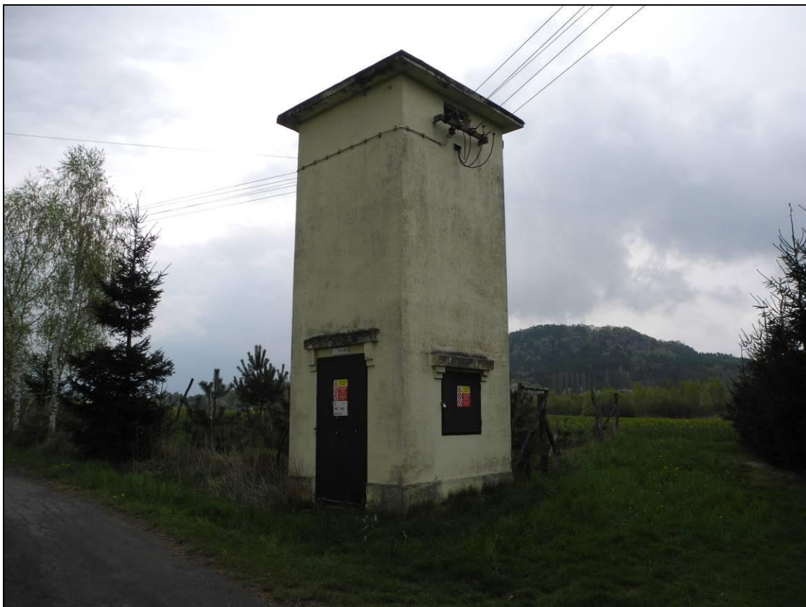
Obrázek 241. Trafostanice Honsob, pohled na nové vstupní dveře a nová dvířka rozvaděče. Okno zazděno, logo DZD také, trafostanice nově omítnuta. Foto Jiří Chmelenský, 2015.
