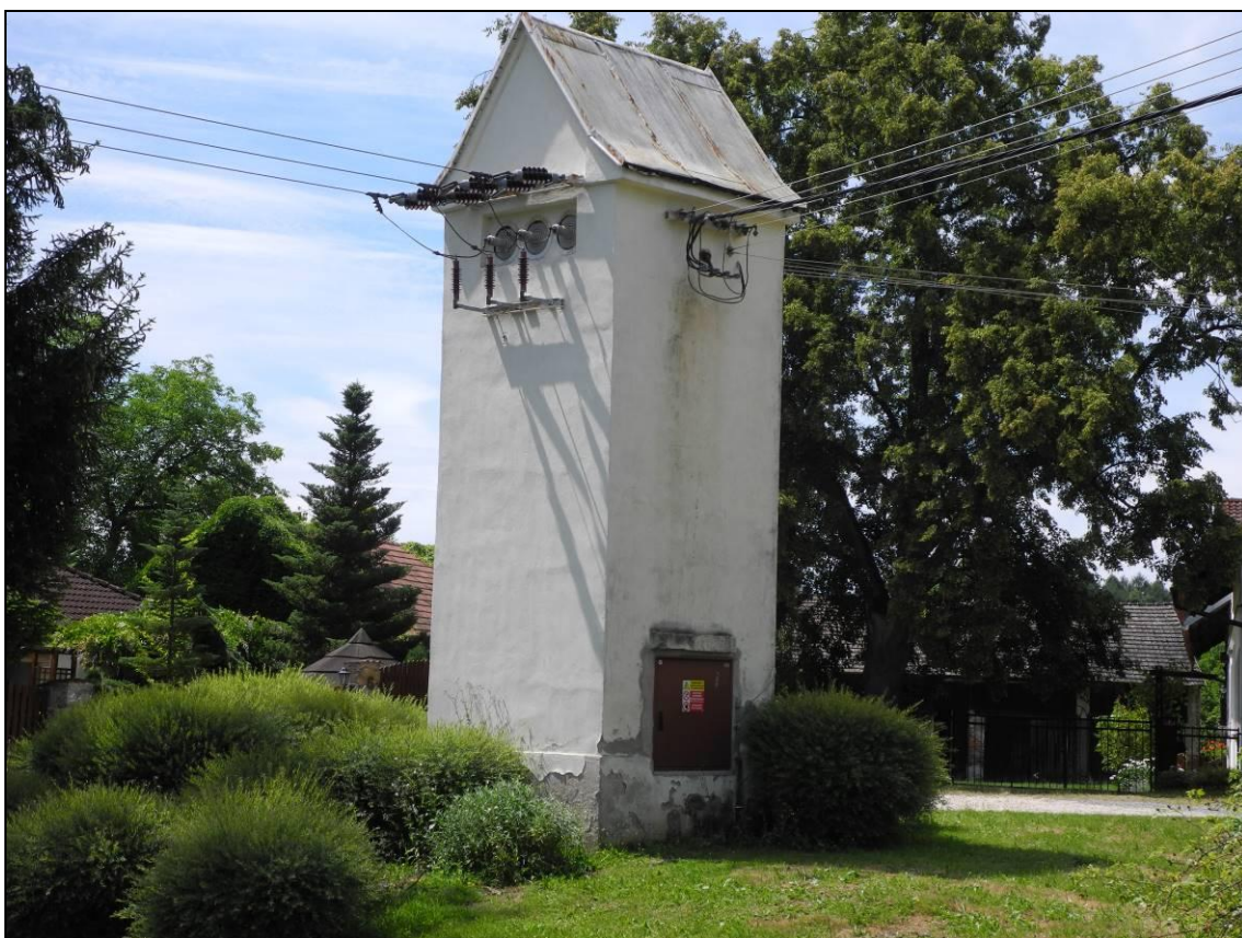
Obrázek 260. Trafostanice typ DZD v Maníkovcích po přestavbě. Foto Jiří Chmelenský, 2015.
