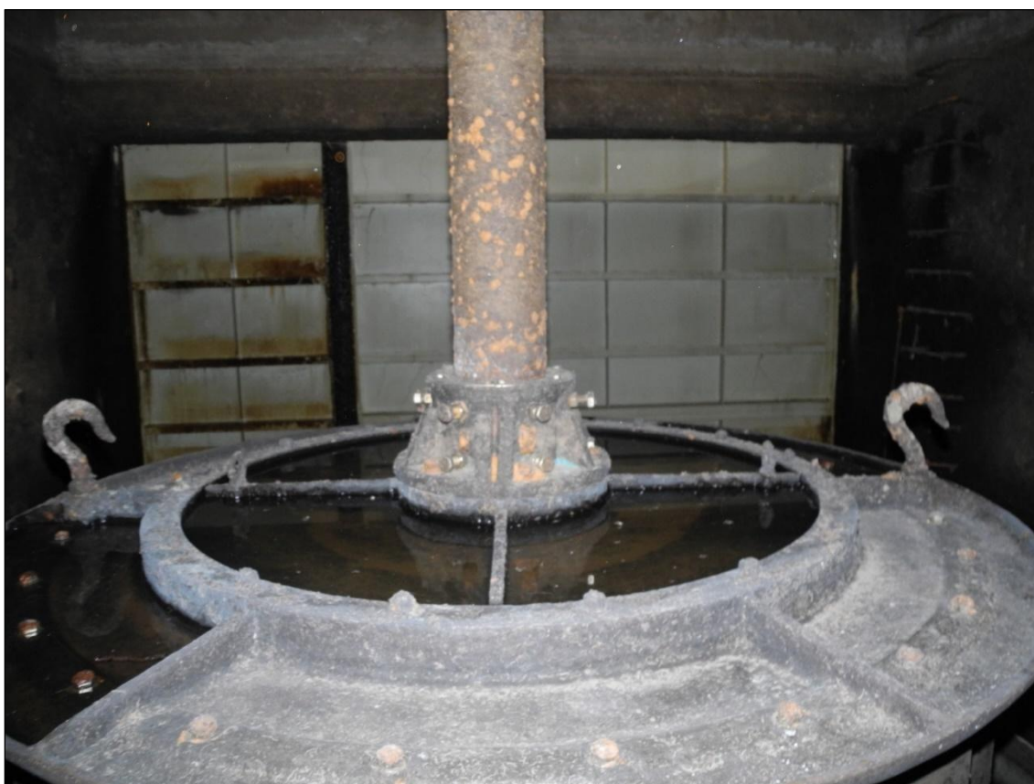
Obrázek 142. Pohled přes kryt Francisovy turbíny I proti vodě na zavřená vrata turbínové kašny. Uprostřed hřídel turbíny a háky k manipulaci s krytem turbíny. Foto Jiří Chmelenský, 2015.
