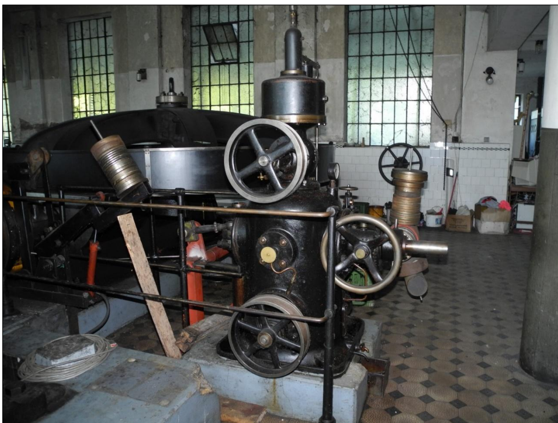
Obrázek 161. Olejový regulátor I Francisovy turbíny, vzadu zvonové kolo I. Foto Jiří Chmelenský, 2015.
