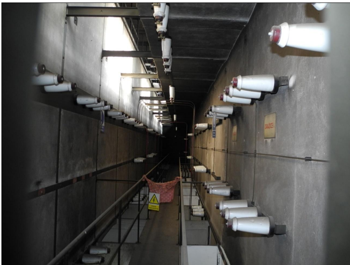
Obrázek 183. Pohled do rozvodny 22 kV s vymezením nebezpečného prostoru (hadr) napětí 22 kV. Foto Jiří Chmelenský, 2015.
