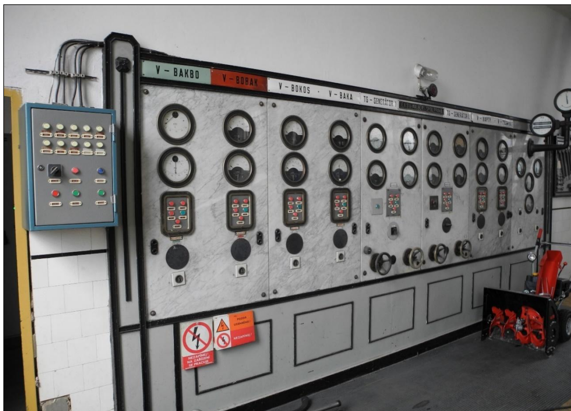
Obrázek 137. Původní rozvodná deska od firmy Kolben a spol., a. s. ve strojovně MVE Bakov. Foto Jiří Chmelenský, 2015.
