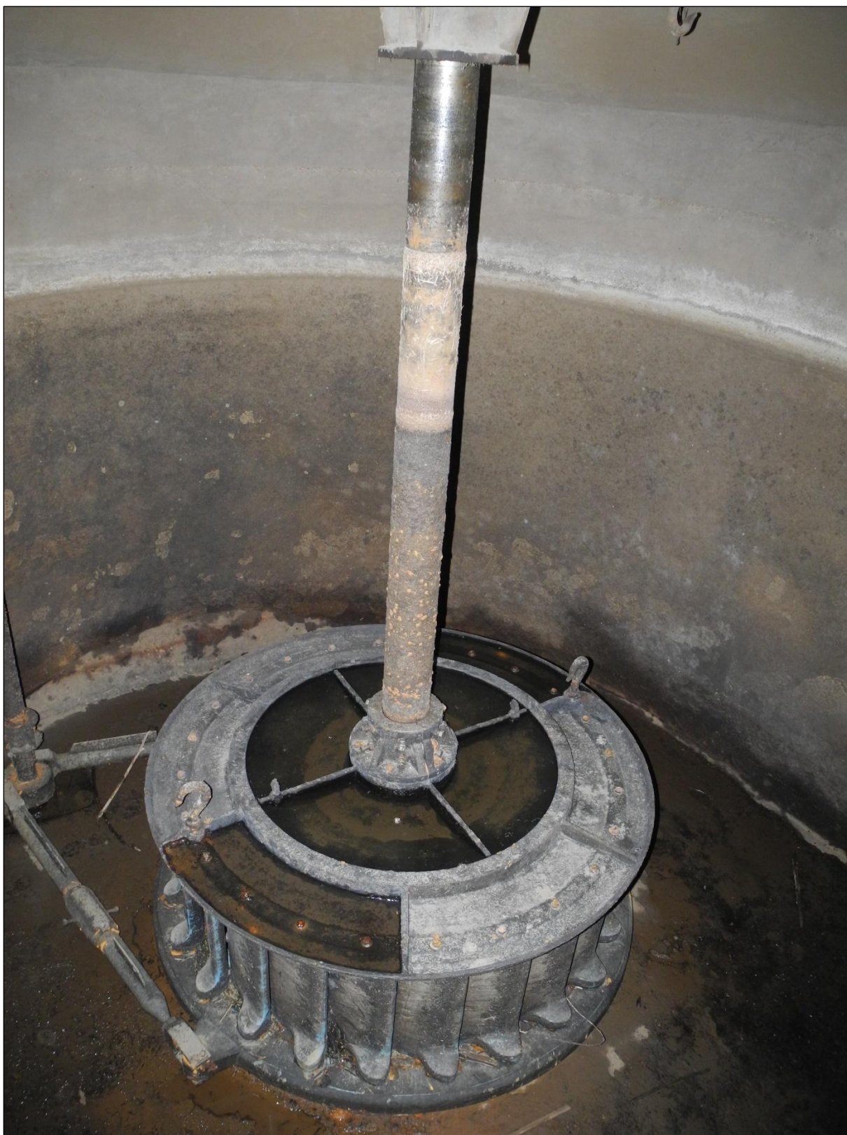
Obrázek 143. Pohled na Francisovu turbínu I z průřezného otvoru kašny. Vpravo pod stropem hák k manipulaci s krytem turbíny. Vlevo regulační táhla krytu. Foto Jiří Chmelenský, 2015.
