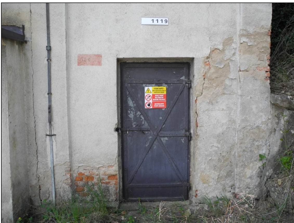
Obrázek 294. Originální vchodové dveře do trafostanice Bakov n. J., Rybničná ulice. Foto Jiří Chmelenský, 2015.
