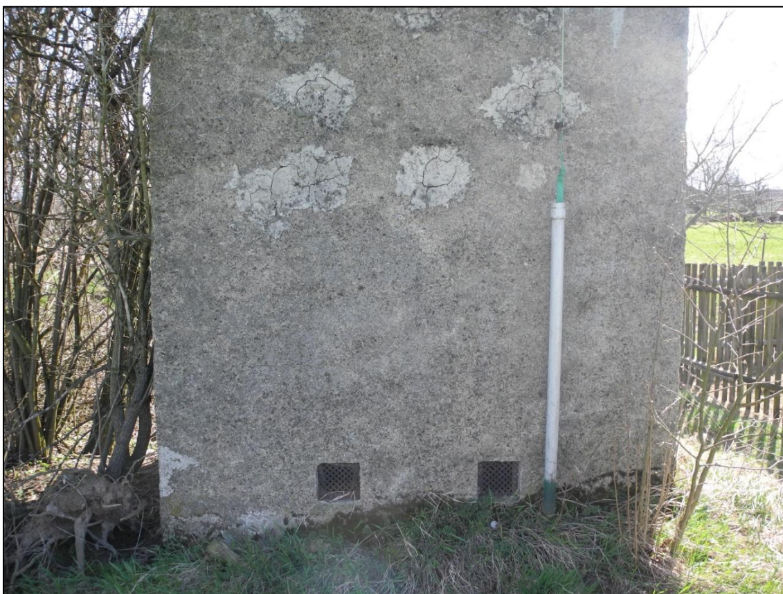
Obrázek 272. Ventilační mřížky trafostanice Neveklovice, uzemnění a stopy po úpravě uchycení transformátoru uvnitř. Foto Jiří Chmelenský, 2015.
