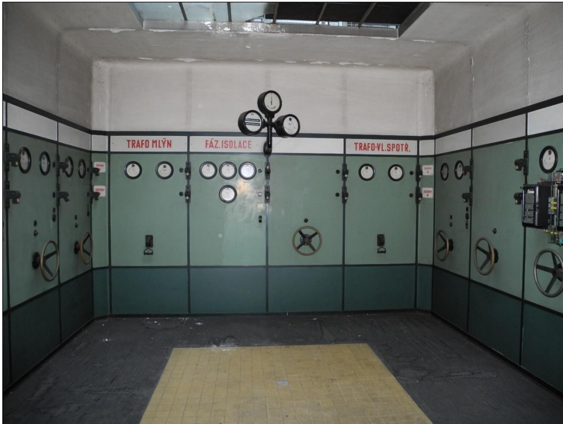
Obrázek 170. Rozvodna 6,3 kV. Odpovídá původnímu stavu. Foto Jiří Chmelenský, 2015.
