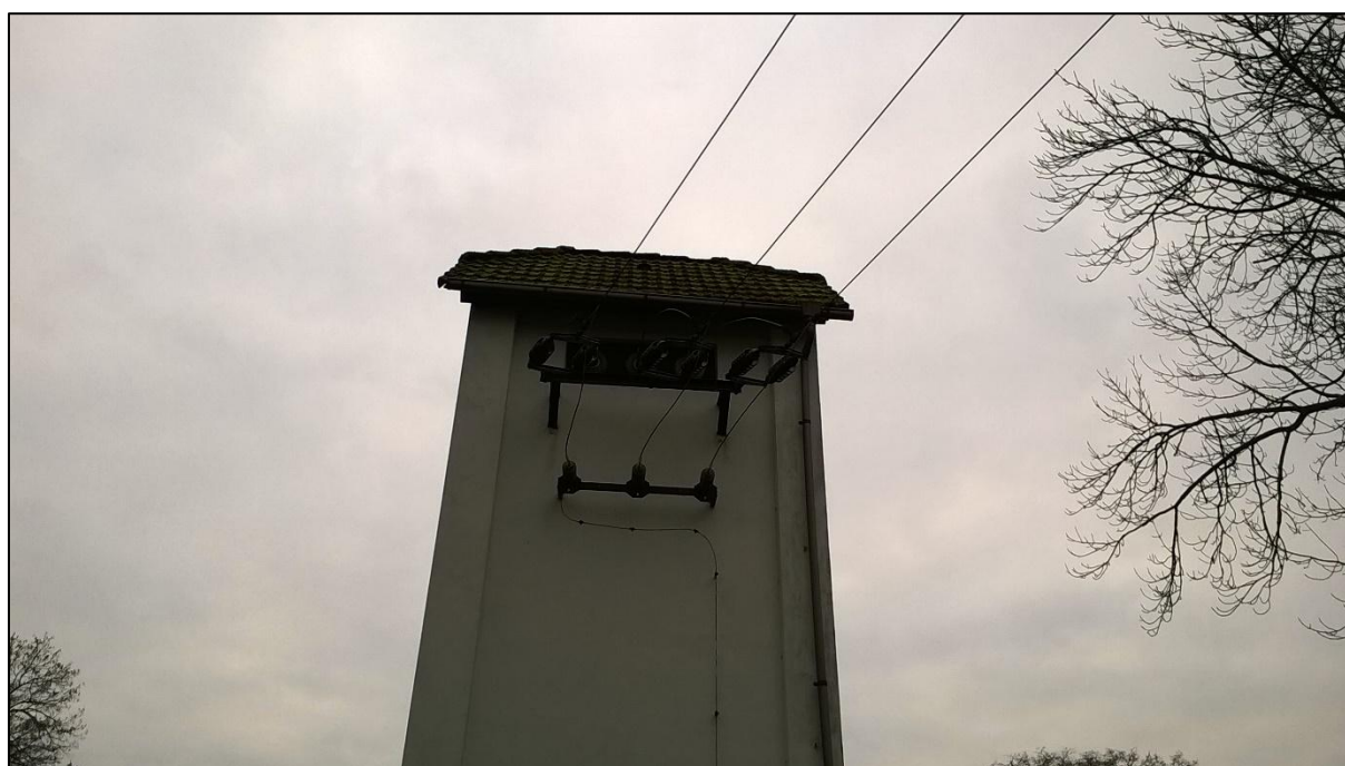
Obrázek 297. Nenormovaná trafostanice Veselá, pohled na vstupy vn. Foto Jiří Chmelenský, 2015.
