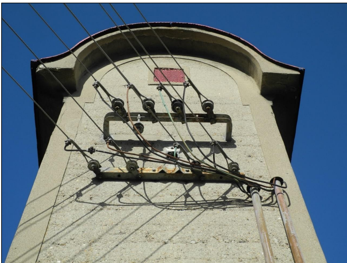
Obrázek 275. Trafostanice Obruby, detail výstupů nn. Foto Jiří Chmelenský, 2015.
