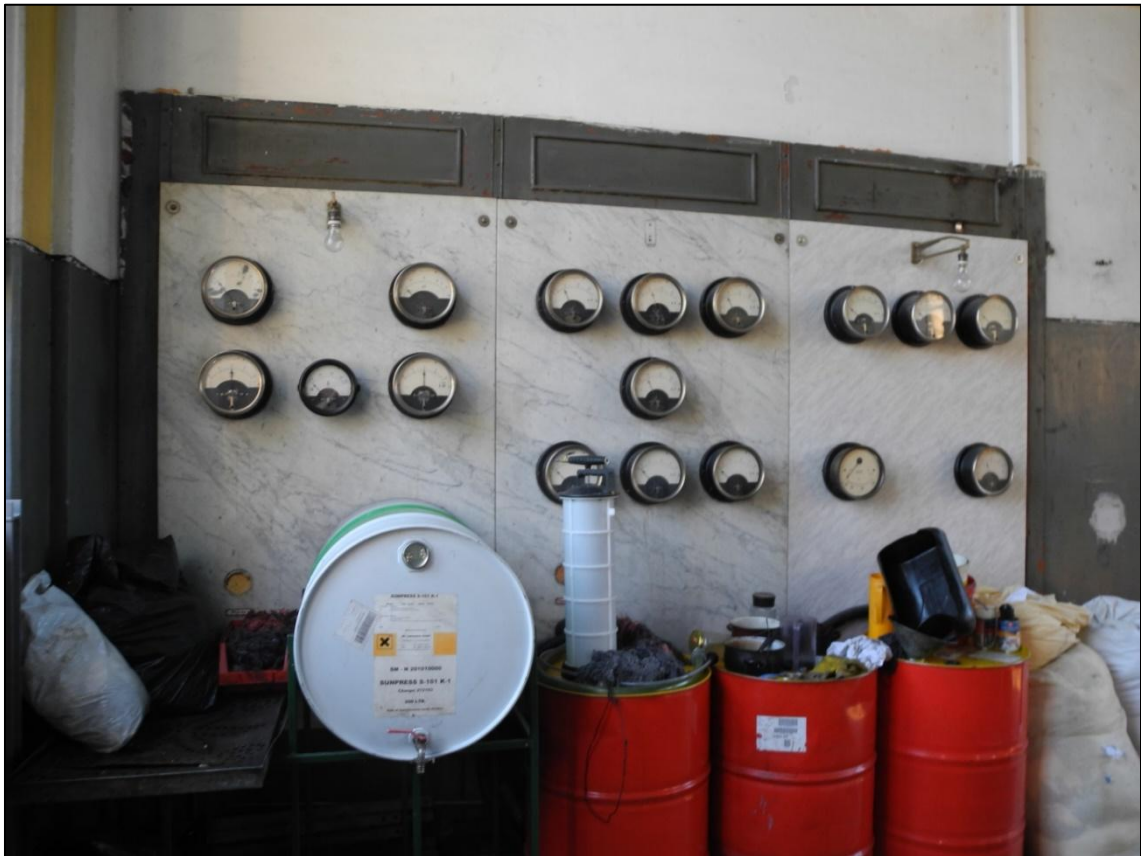
Obrázek 95. Původní rozvodná deska, nyní odpojená. Rozvodna byla plně digitalizována. Foto Jiří Chmelenský, 2015.
