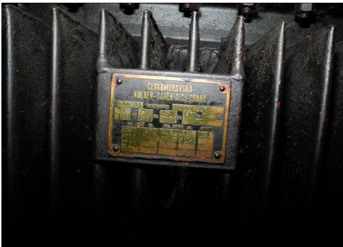
Obrázek 173. Detail štítku transformátoru typu 13TZ30 převodu 6,3 kV na 0,4 kV výroby firmy Českomoravská-Kolben-Daněk a. s. Praha. Foto Jiří Chmelenský, 2015.
