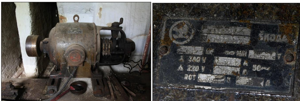
Obrázek 46. Kroužkový elektromotor Škoda s odklápěčem, o výkonu 7,5 kW, typu SS 123 Z/4-0. Panský mlýn čp. 4, Starosedelský Hrádek, okr. Příbram. Foto Rudolf Šimek, 2016.
