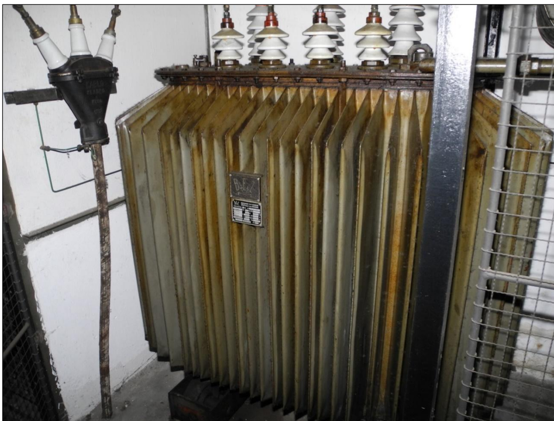
Obrázek 182. Třífázový transformátor výroby Bratislavských elektrotechnických závodů typ aTO 34/22 s převodem 6,3 kV na 22 kV. Foto Jiří Chmelenský, 2015.
