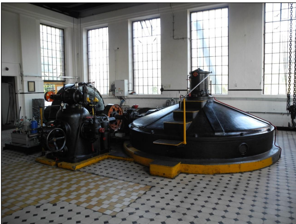
Obrázek 114. Turbína I od firmy Josef Prokop a synové o výkonu 238 ks. V popředí olejový regulátor turbíny a za ním se nachází generátor. Foto Jiří Chmelenský, 2015.
