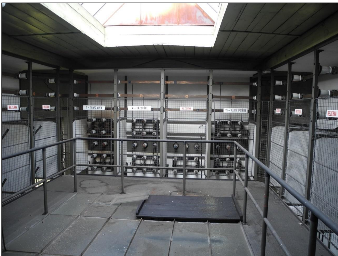
Obrázek 178. Vrchní patro rozvodny se sběrnými a průchodkami napětí 6,3 kV. Foto Jiří Chmelenský, 2015.
