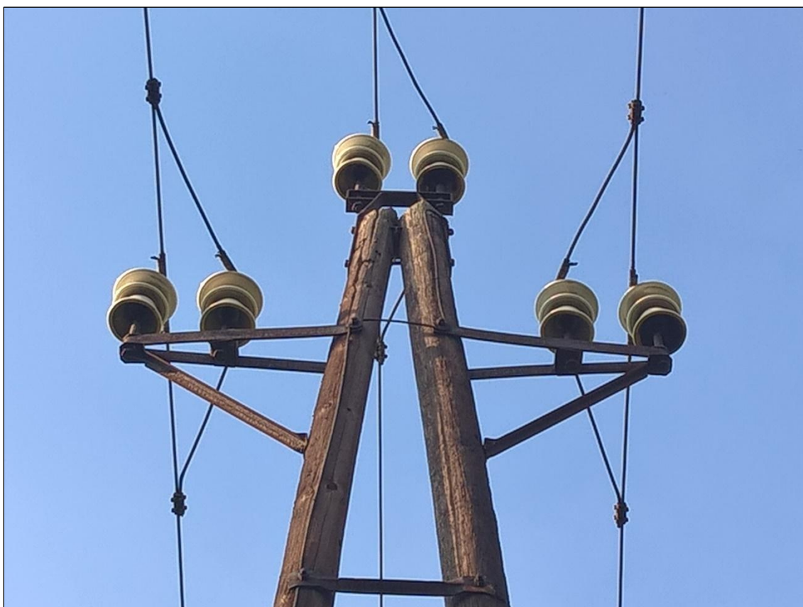
Obrázek 193. Dřevěný vzepřený dvojitý sloup u Mnichova Hradiště z doby výstavby firmou L&K. Pohled na nosníky izolátorů a izolátory samotné, byly zkoušeny proti průrazu 76 kV. Foto Jiří Chmelenský, 2015.
