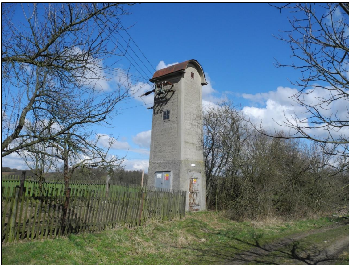
Obrázek 271. Trafostanice Neveklovice dochovaná téměř v původním stavu. Foto Jiří Chmelenský, 2015.
