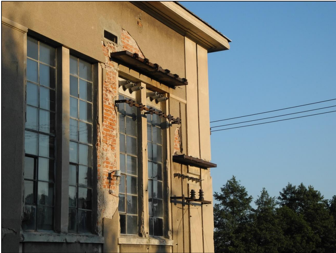
Obrázek 89. Vysokonapět'ové vývody na 5,25 kV na západní stěně elektrárny. Foto Jiří Chmelenský, 2015.
