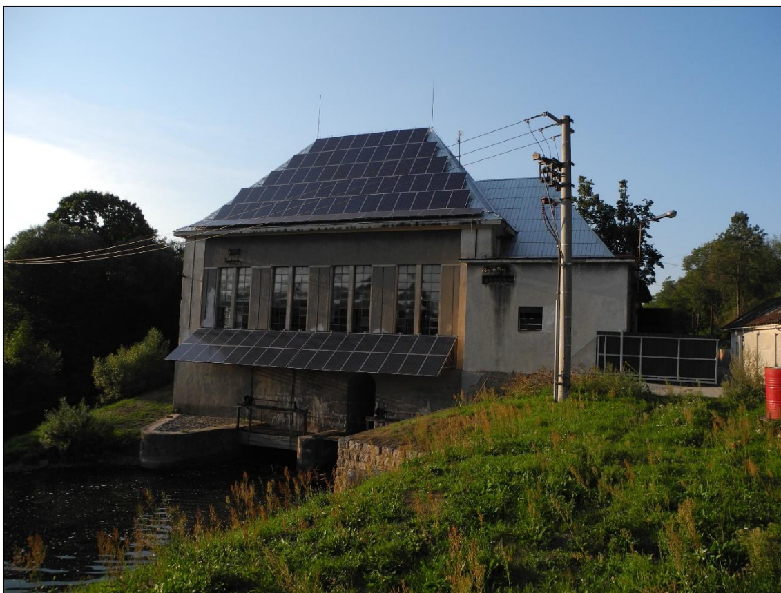
Obrázek 87 Pohled na MVE Hněvousice od jihu. V popředí, vpravo, nyní už nepoužívaná rozvodna 22 kV. Foto Jiří Chmelenský, 2015.
