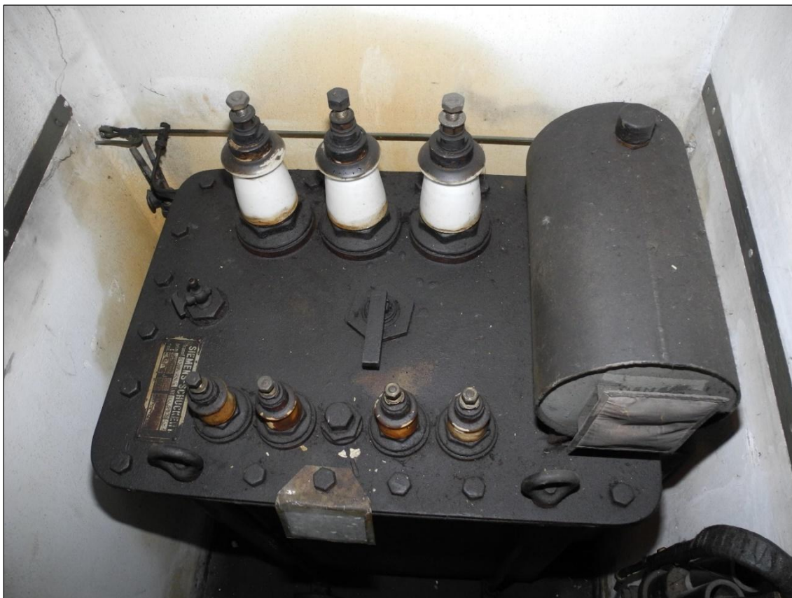
Obrázek 176. Transformátor Siemens Schuckert typ KO206/6IIa s převodem 6,3 kV na 0,4 kV. Foto Jiří Chmelenský, 2015.
