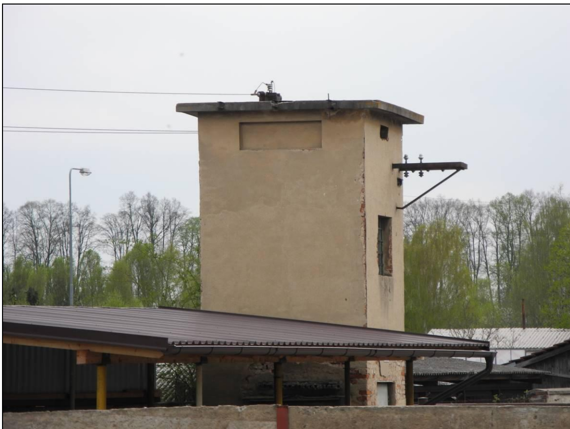
Obrázek 266. Trafostanice typ DZD Mnichovo Hradiště průmyslová zóna východ, pohled na změněné vstupy vn. Foto Jiří Chmelenský, 2015.
