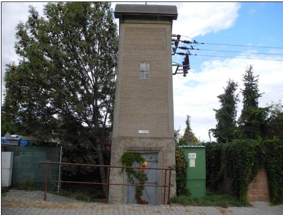
Obrázek 235. Boční pohled na trafostanici typu L&K. v Jemníkách. Foto Jiří Chmelenský, 2015.
