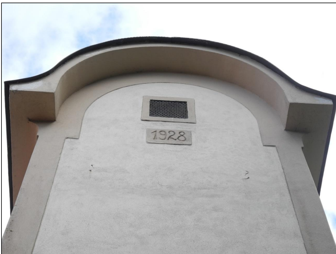
Obrázek 248. Datace trafostanice Husí Lhota. Patrné stopy po odstraněné konzoli nn. Foto Jiří Chmelenský, 2015.
