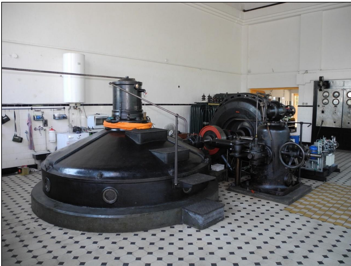
Obrázek 113. Pohled na turbínu II o výkonu 438 ks od firmy Josef Prokop a synové. Vzadu generátor a zcela vzadu rozvodná deska. Foto Jiří Chmelenský, 2015.
