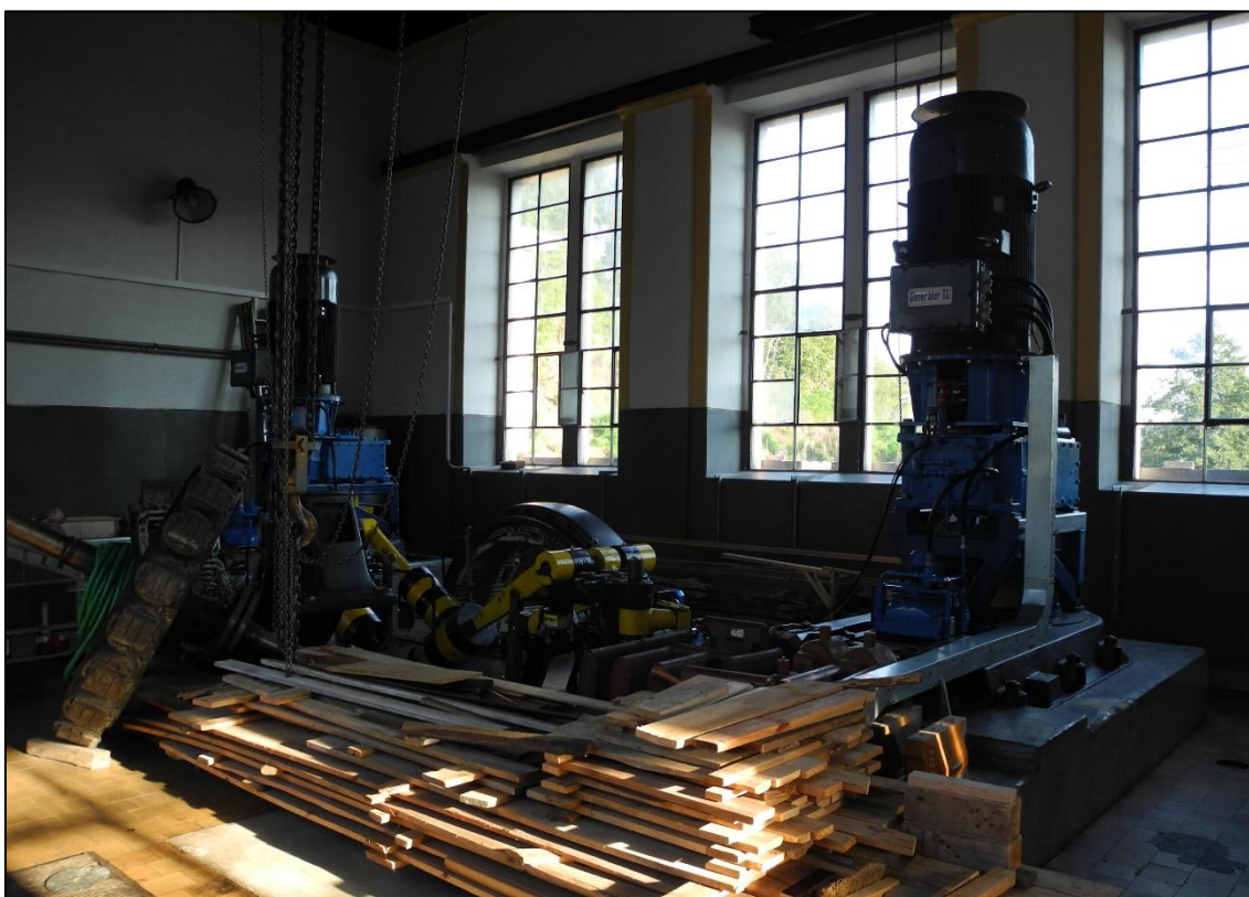
Obrázek 92. Pohled na oba nové generátory. Mezi nimi je patrná horní polovina statoru původního generátoru. Foto Jiří Chmelenský, 2015.
