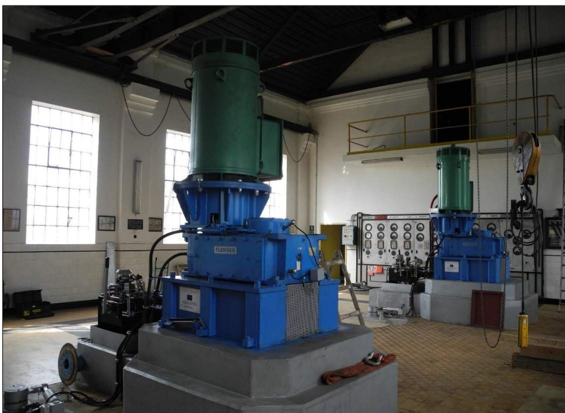
Obrázek 136. Pohled k jihozápadu na strojovnu MVE Bakov. Vzadu patrná původní, dnes odpojená, rozvodná deska, nad ní galerie nové rozvodny. Foto Jiří Chmelenský, 2015.
