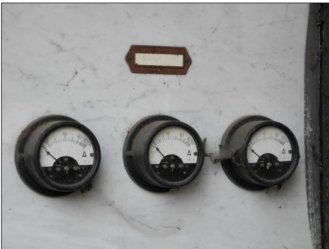
Obrázek 224. Poslední tři dochované ampérmetry v rozvodné skříni trafostanice Dolní Cetno. Foto Jiří Chmelenský, 2015.
