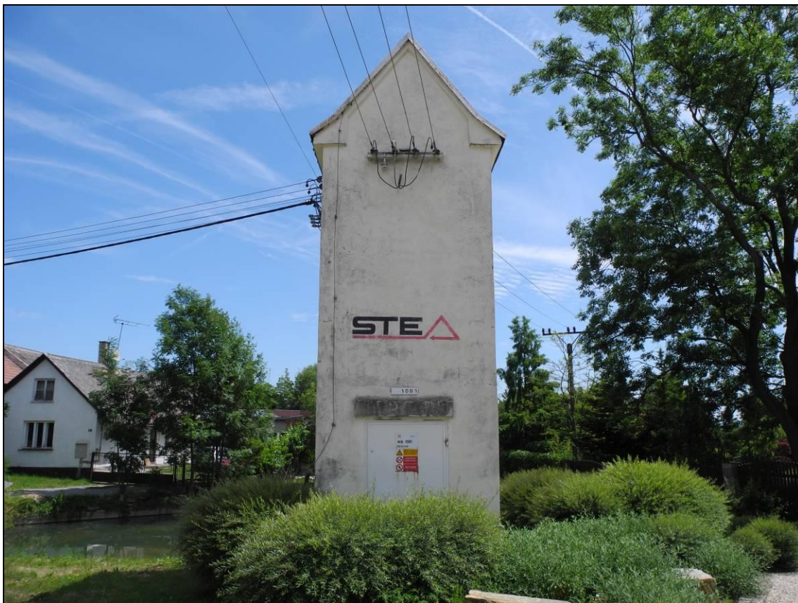
Obrázek 259. Trafostanice typu DZD opatřena sedlovou střechou. Foto Jiří Chmelenský, 2015.
