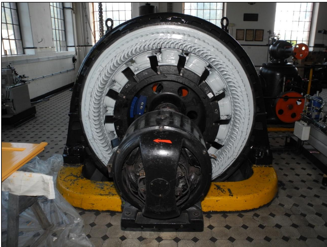
Obrázek 112. Generátor I o výkonu 245 kVA s budičem, obojí výroby František Křížík a. s. Foto Jiří Chmelenský, 2015.
