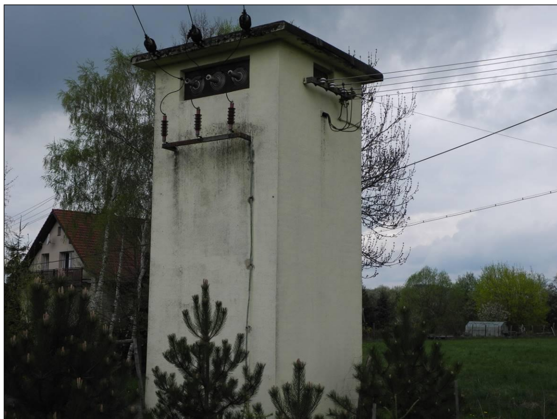
Obrázek 242. Trafostanice Honsob, pohled na vstupy vn (vlevo), výstupy nn (vpravo). Foto Jiří Chmelenský, 2015.
