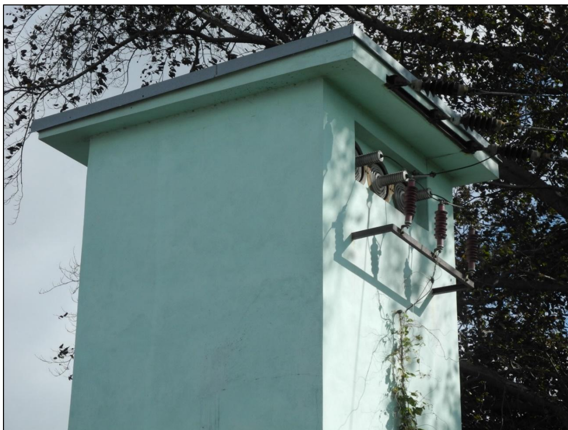
Obrázek 221. Detail vstupů vn do trafostanice Dolní Bousov. Foto Jiří Chmelenský, 2015.
