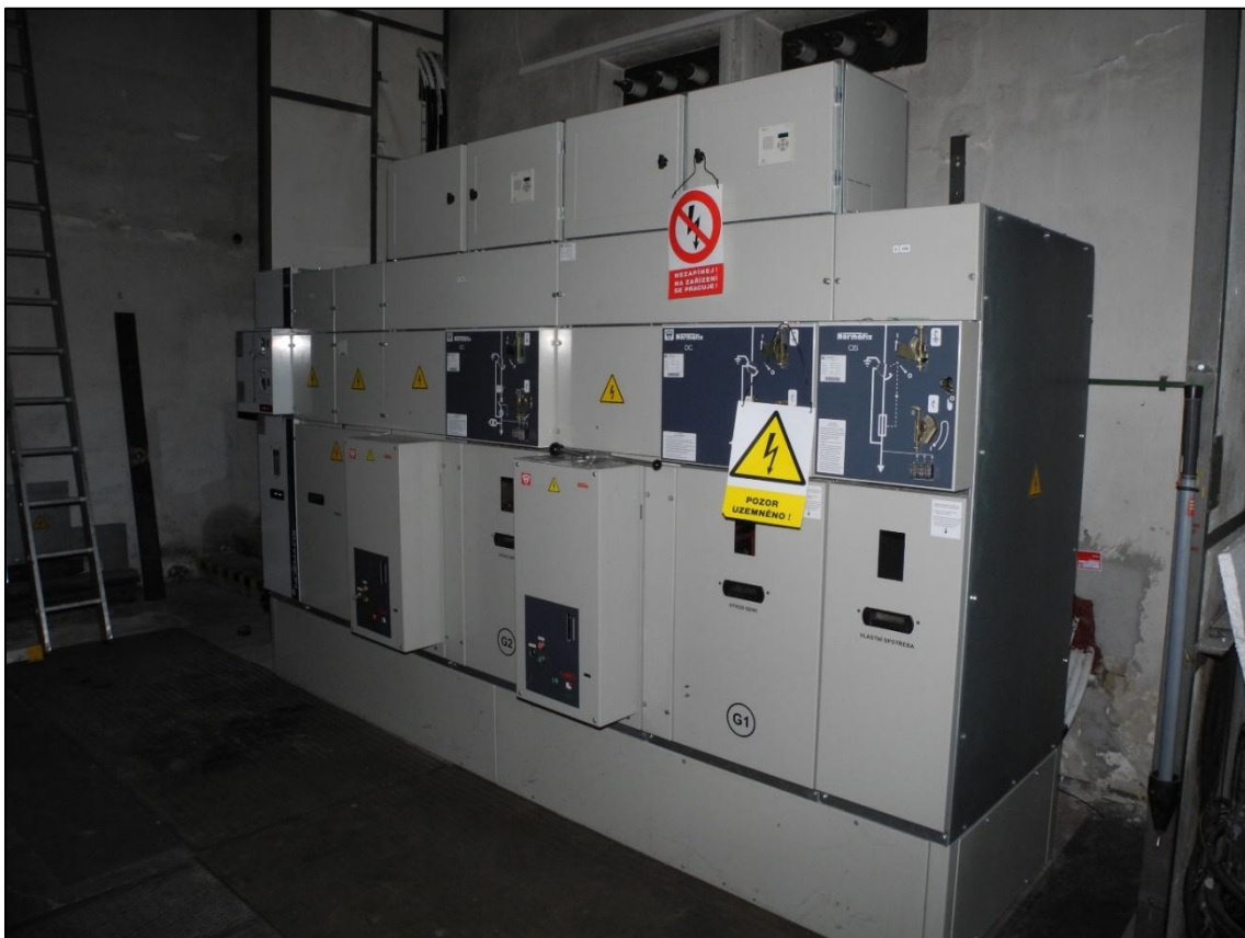
Obrázek 120. Nová rozvodna instalovaná v prostorách staré rozvodny MVE Haškov. Foto Jiří Chmelenský, 2015.
