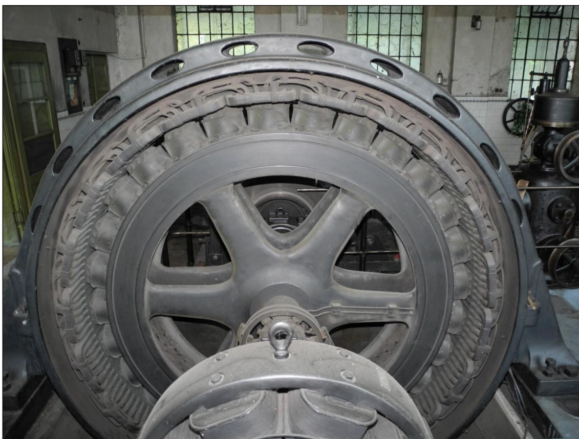
Obrázek 163. Čelní pohled na generátor II od firmy SIEMENS SCHUCKERT WId 175/214 o výkonu 214 kW opatřený budičem. Foto Jiří Chmelenský, 2015.
