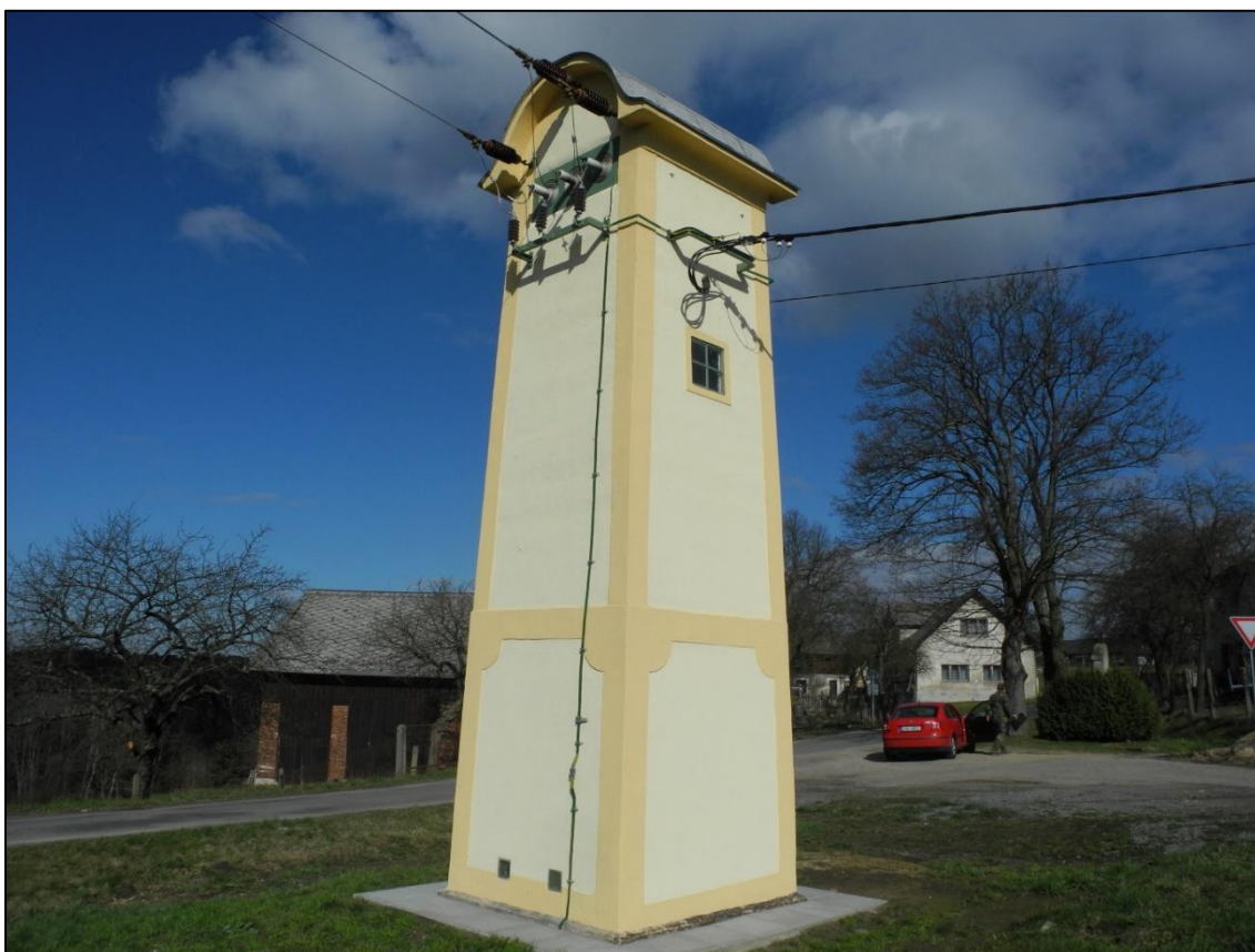
Obrázek 278. Trafostanice Ouč, pohled na vstupy vn a boční okno. Foto Jiří Chmelenský, 2015.
