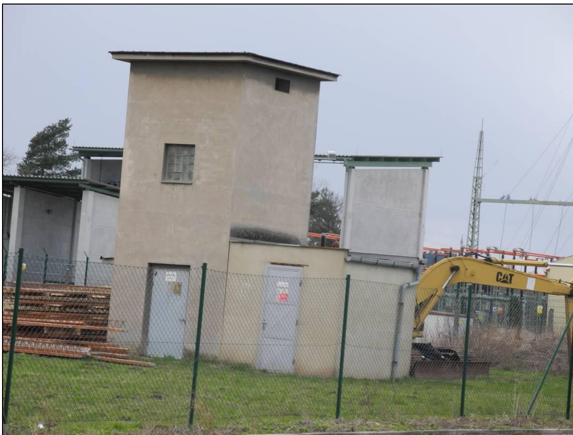
Obrázek 262. Přestavěná trafostanice typu DZD Mnichovo Hradiště ČSAD. Místo loga DZD proraženo prosvětlovací okno. Foto Jiří Chmelenský, 2015.
