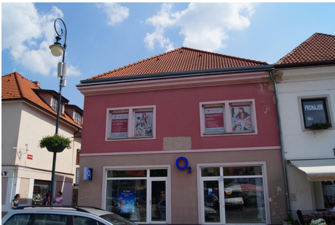
Obr. č. 5: Nevkusné reklamní polepy na oknech domu č. p. 85, Husovo náměstí.
