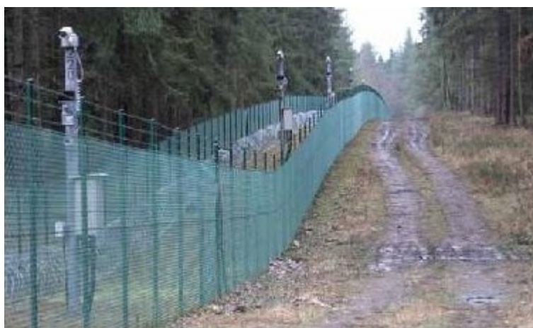
Obr. č.4 : Systém elektronického zabezpečení objektu [51]
