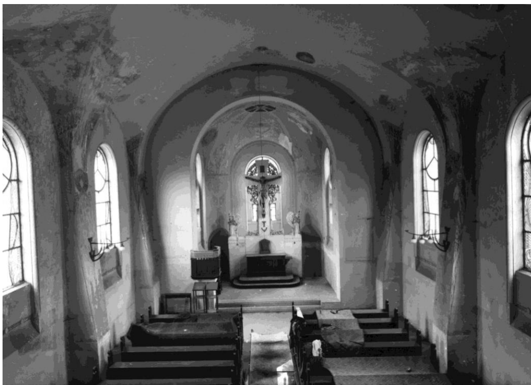
Obr. č. 28 Starokatolický kostel Povýšení sv. Kříže – loď kostela poničená v důsledku zatékání.
