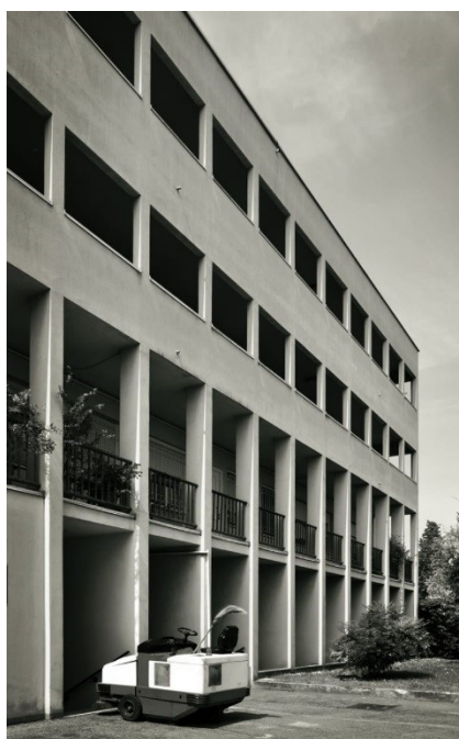
Obrázek č. 50 Dům od Aldo Rossiho, Gallarate housing. Detail balkónů. Zdroj: https://divisare.com/projects/340795-aldo-rossi-burcin-yildirim-gallaratese-housing-d-block#lg=1&slide=8
