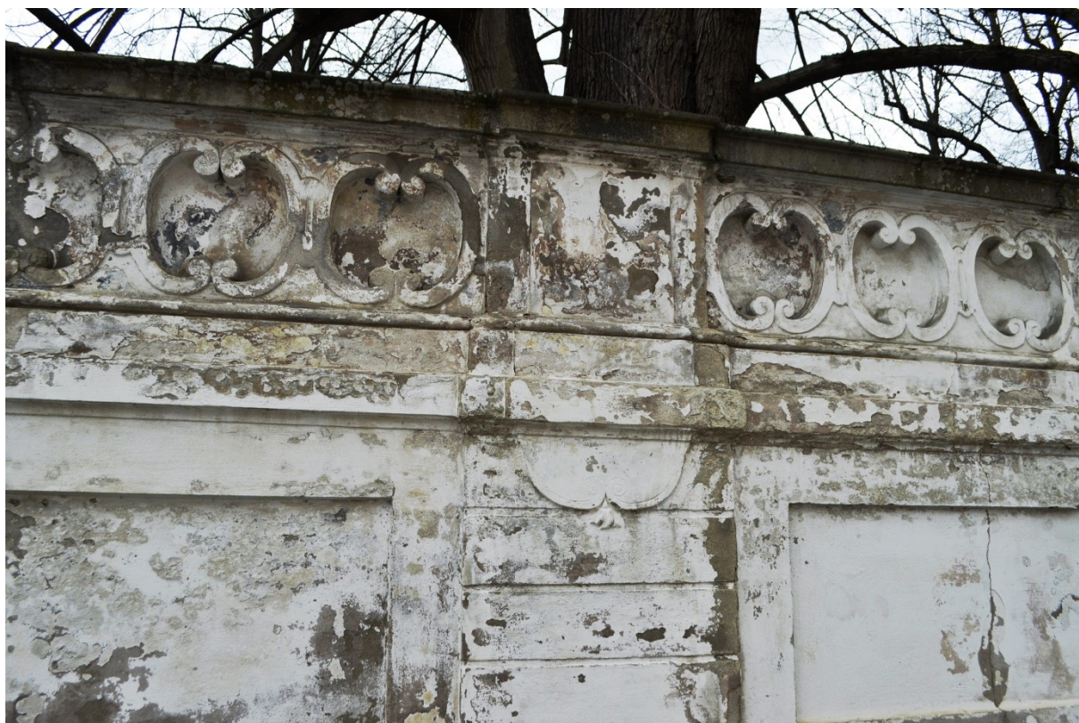
41. Opěrná zeď s parapetem před zimní jízdárnou při zahradě v Českém Krumlově. Archiv autora
