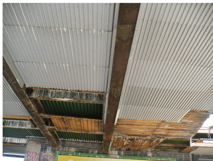
Obr. 35. Nádraží Ostrava - Vítkovice. Exteriér nádraží. Detail - markýzy opláštěné vlnitým hliníkem-velmi poničené. 2019
