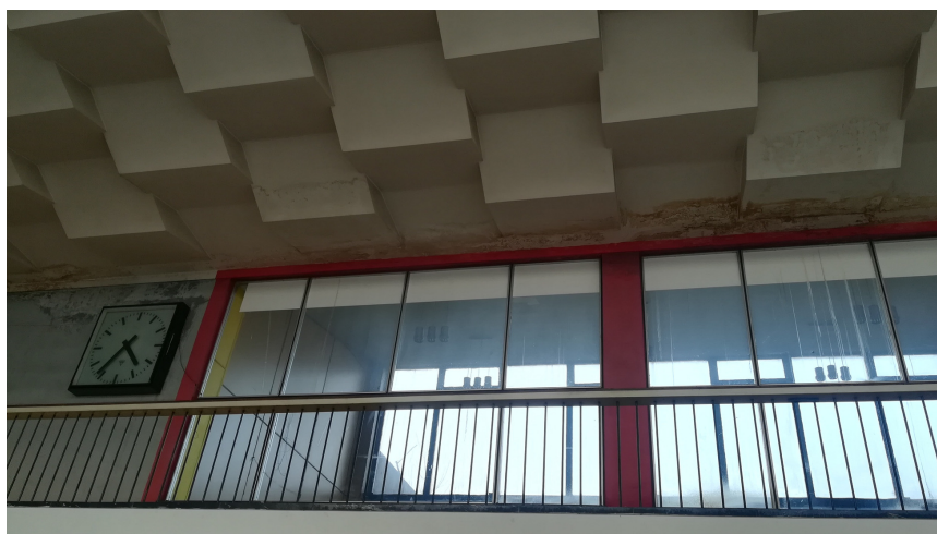
Obr. 50. Nádraží Havířov- detail zničeného promočeného stropu. 2018
