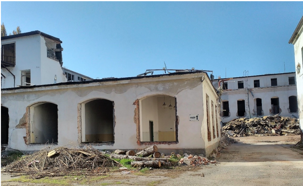
Obrázek 11: Zpustošený stav budov Sola Sušice
