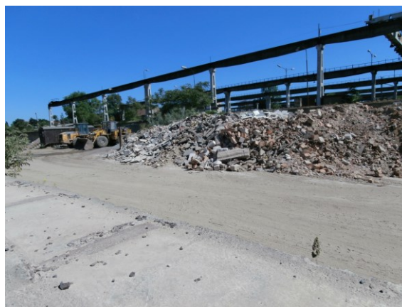
Obr. 147: Současný stav panelárny, dochází k likvidaci, v budoucnu by zde měla vézt cyklostezka skrz odpočinkovou zónu Foto: J. Brabec (2017)
