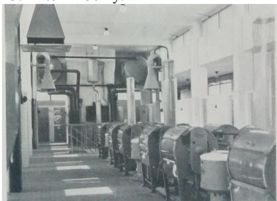
a) zařízení strojové prádelny pro domy OPAS, dobová fotografie, zřejmě rok 1934
