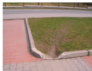
Přirozená demolice obrubníku – neměl stát v cestě!
