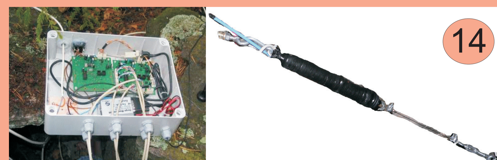
Obr. 14: Centrála a přenosový modem automatického monitoringu, vpravo indukční extenzometr
