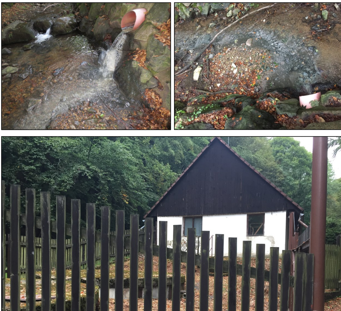
Obr. 50 – Výtok odpadních vod do toku – „ČOV“ pod obcí Mikulov. Zdroj: (foto M. Jonáš)
