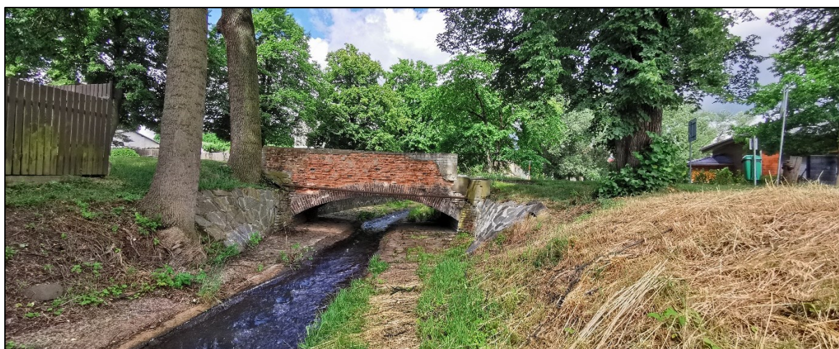
Obr. 71 – Nízkokapacitní cihlový most v sousedství profilů P3 a P4. Zdroj: (foto Milada Matoušková)
