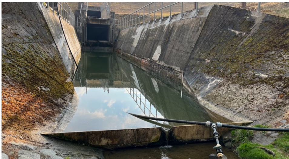
Obrázek 25: odtokový kanál s měrným přelivem (foto: archiv autora)
