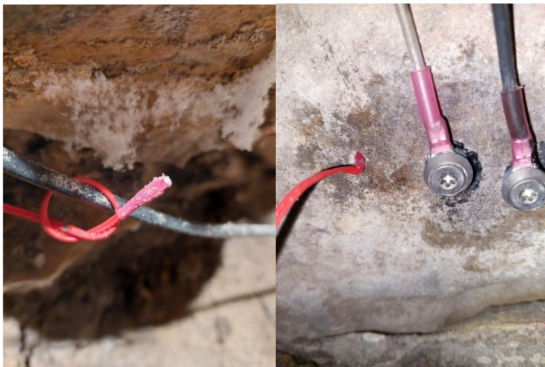
Obr. 71. Čidla Material Moisture Gigamodule pro měření teploty vzduchu (vlevo) a zdiva (vpravo).
