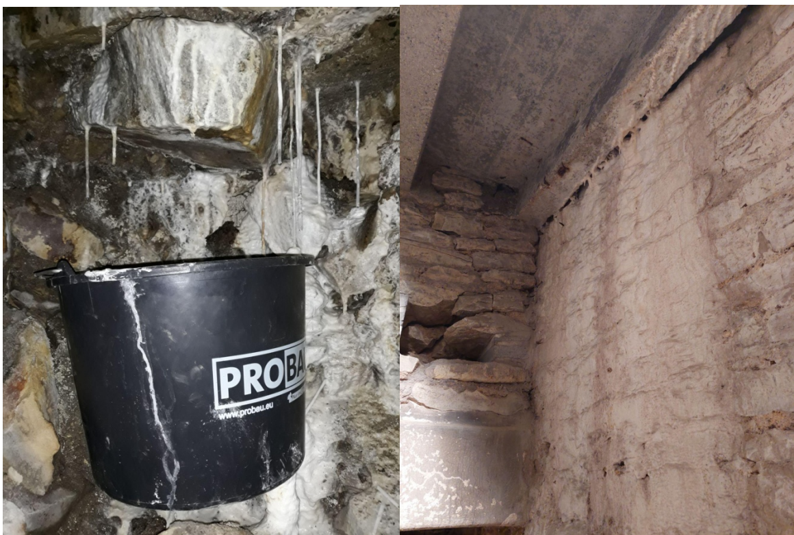
Obr. 56. Fotografie vlevo - krápníky a solné krusty, pod železobetonovým chodníkem pro návštěvníky. Fotografie vpravo - solné krusty na fragmentu zdi kostela sv. Bartoloměje. Vlastní foto autorky.
