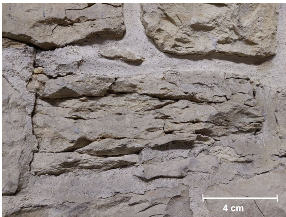
Obr. 57. Fragmenty opukového zdiva v archeologickém areálu pod III. nádvořím Pražského hradu. Zdivo ve výšce cirká 150 cm nad terénem. Praskliny potenciálně způsobené mrazovým zvětráváním opuky ve 20. letech 20. století. Vlastní foto autorky
