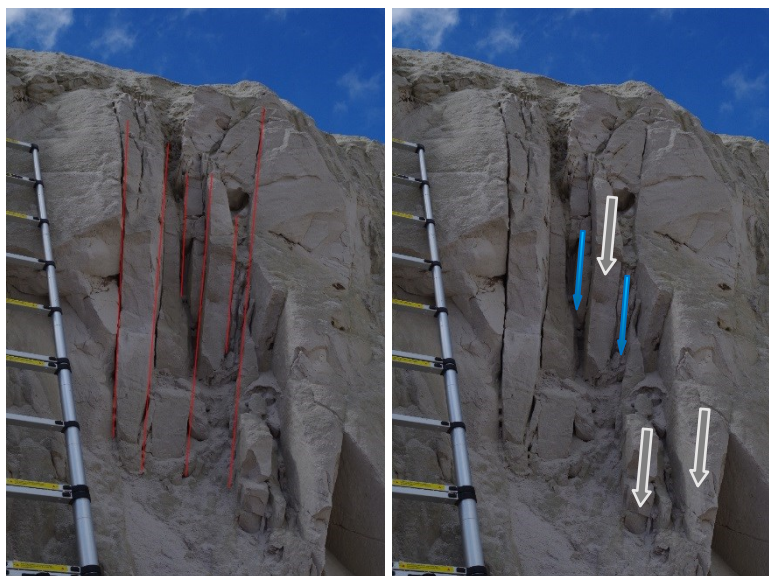
Obrázek 5.20: Pokus 1 – červenými čarami jsou vyznačeny hlavní pukliny; barevnými šipkami jsou vyznačeny převládající erozní mechanismy – modře vymýváním, šedě řícením.
