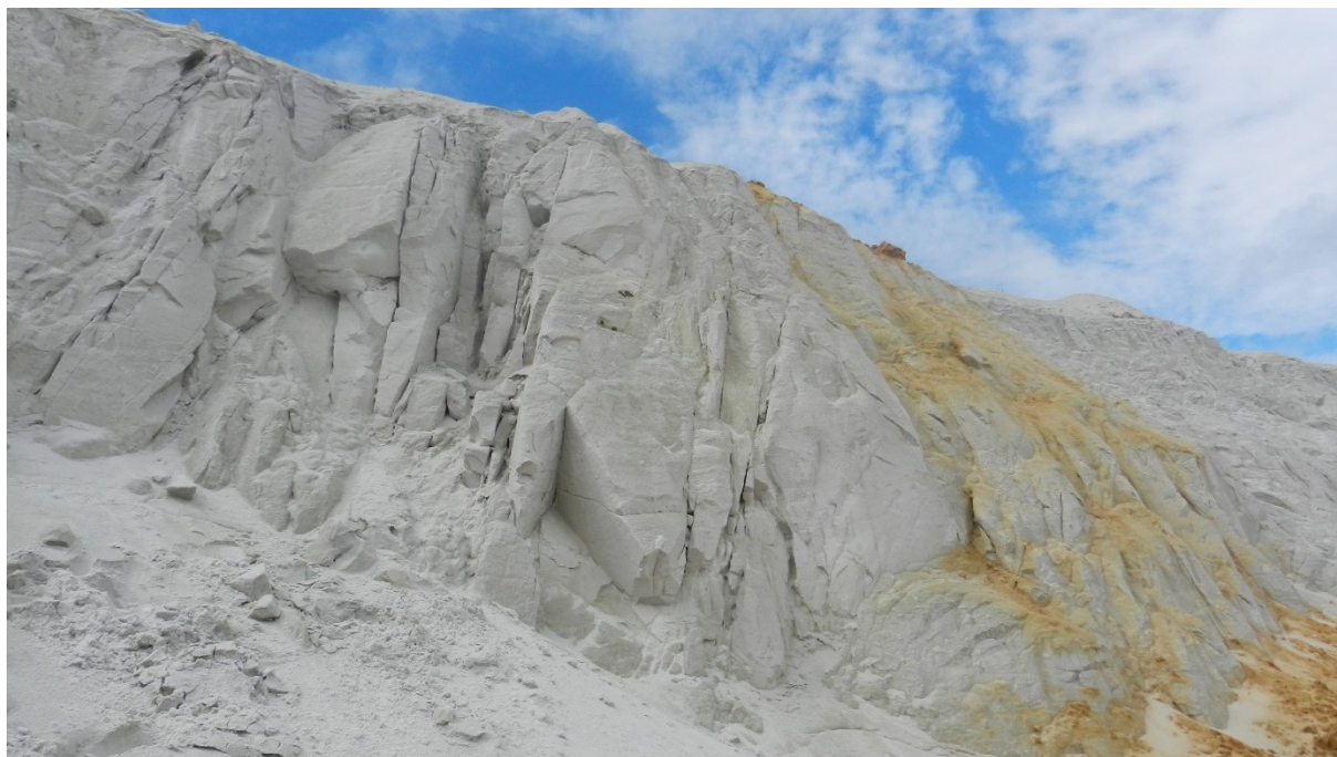
Obrázek 3.10: Rozpukané těleso sklářského pískovce.
